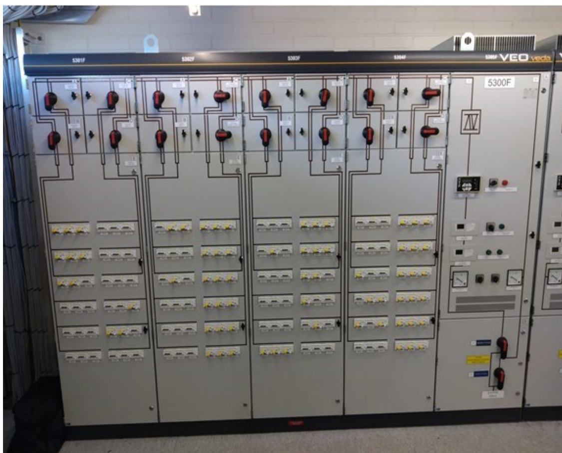
Kuva 8. Uusi sähkölämmityskeskus M028+5300F.
