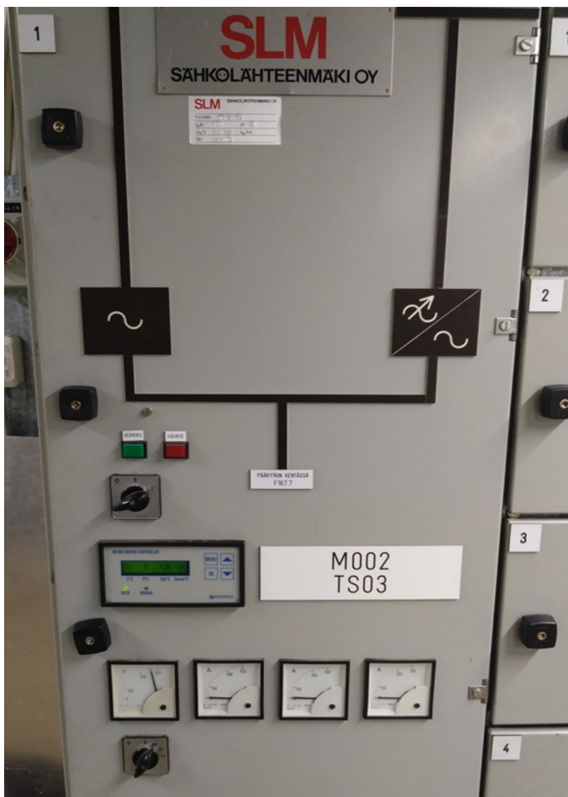
Kuva 5. Vanha sähkölämmityskeskus muuntamolla M002.
