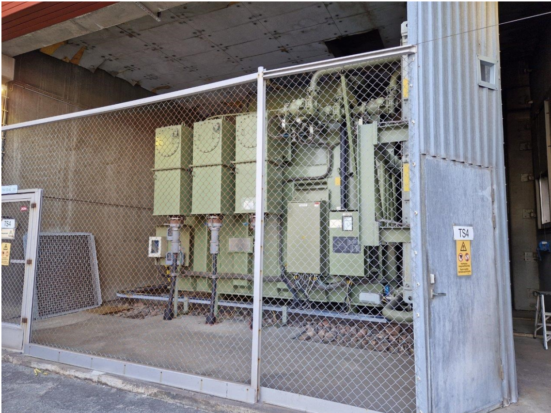
Kuva 1. Yksi neljästä tasasuuntaajamuuntajasta.
