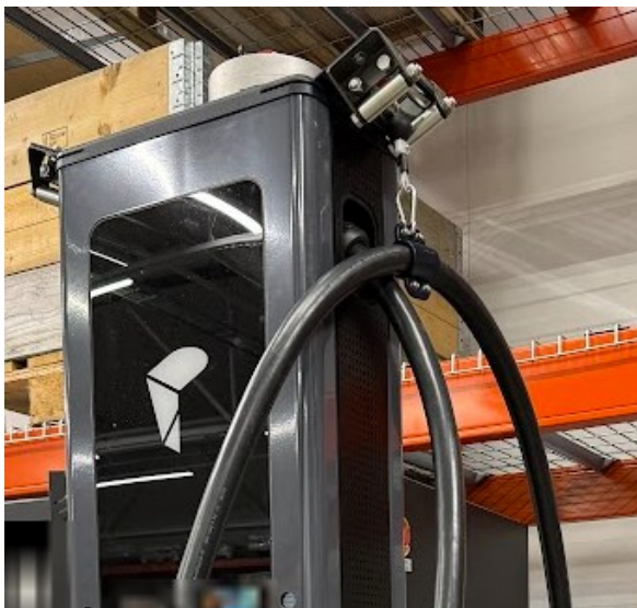
KUVA 10. Latauskaapeli lepotilassa isommalla keventimellä.
