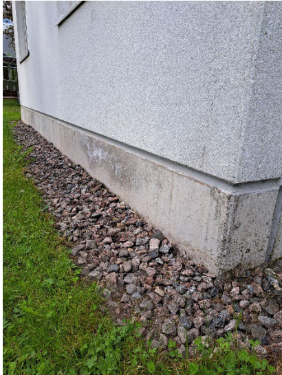
KUVA 31. Sokkelissa merkkejä kunnostuksen tarpeesta.
