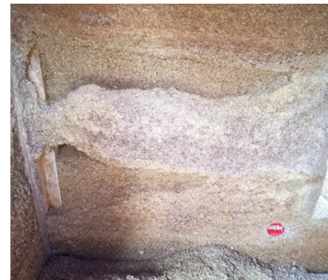
Yhdessä nurkassa, jossa oli käytetty erilaisia sidosaineita testimielessä, kosteus vaikutti haihtuvan hitaammin pois rakenteesta. Epäkelpot kohdat poistettiin ja paikattiin toimivalla seoksella.
