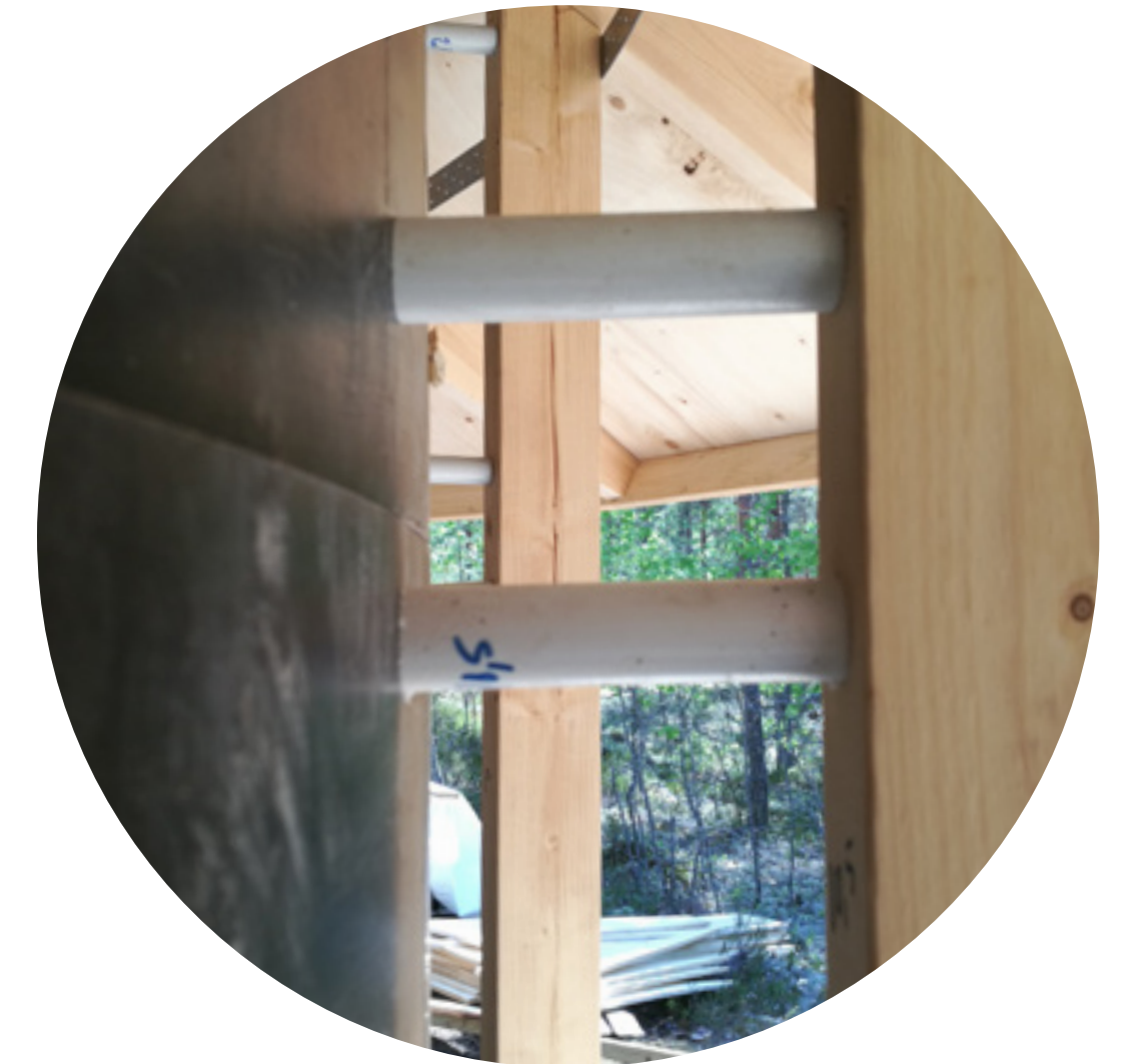
Esimerkki ohjureiden käytöstä. Ruuvit porataan suoja-putkien sisälle, jolloin aukot ovat jälkikäteen helposti täytettävissä. Putket tehdään mittatarkkoina.
