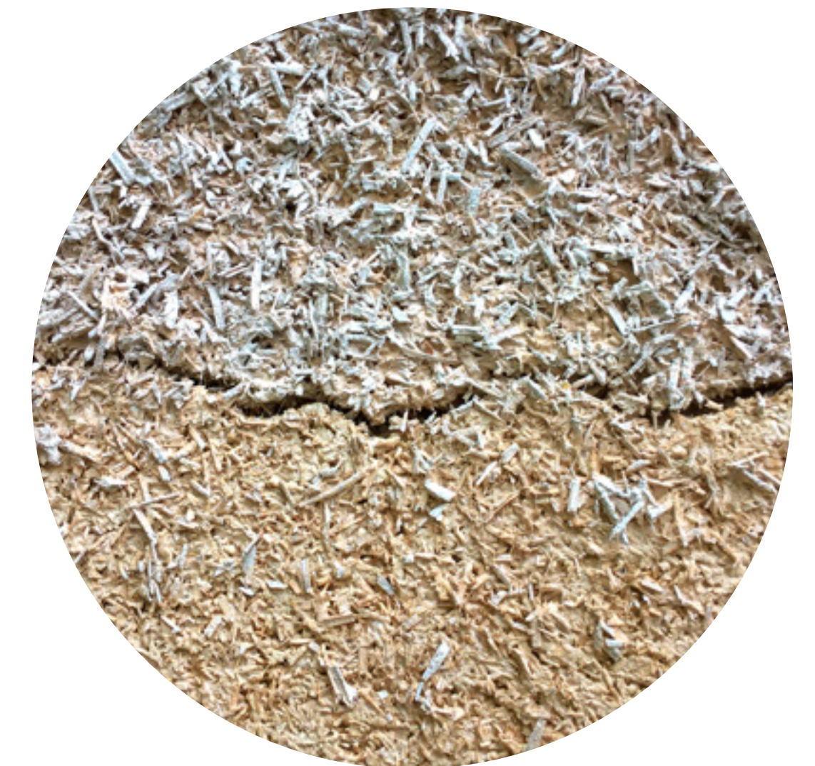
Käsinvaletun ja ruiskuvaletun kerroksen rajapintaan syntyi halkeama kuivumisen aikana, sillä työstötapa ja sidosaine olivat erilaiset.
