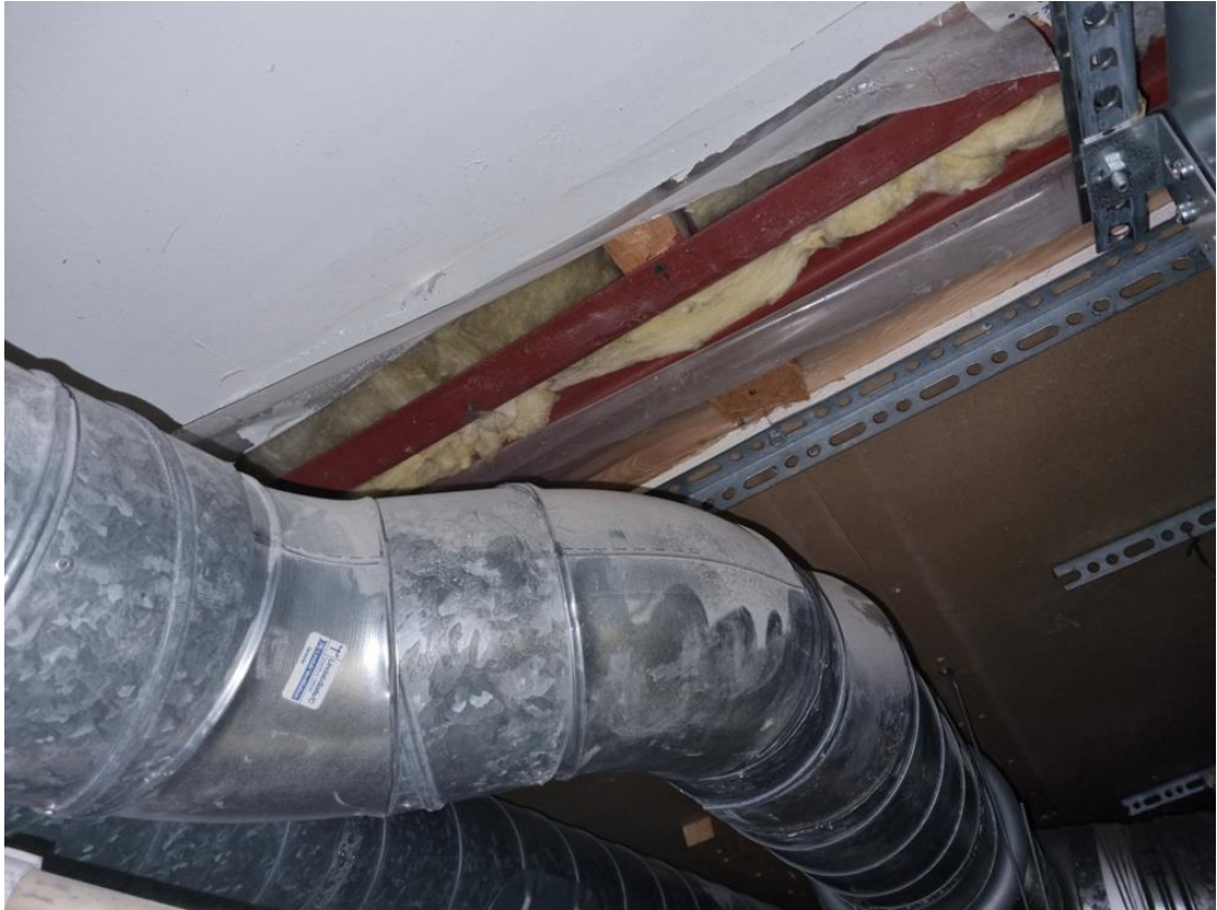
Kuva 16. Yläpohjan höyrinsulkumuovissa todettiin merkittäviä puutteita. Kuva Mikko Niskanen IdeaStructura Oy, 2022
