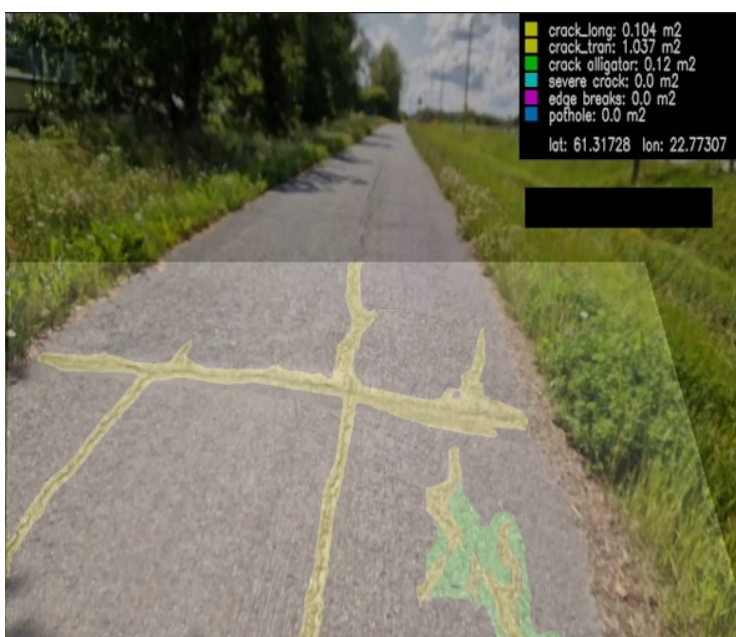
Kuva 11. Esimerkkikuva tyydyttävässä kunnossa olevasta kävely- ja pyöräilyväylästä (AFRY Finland Oy).
