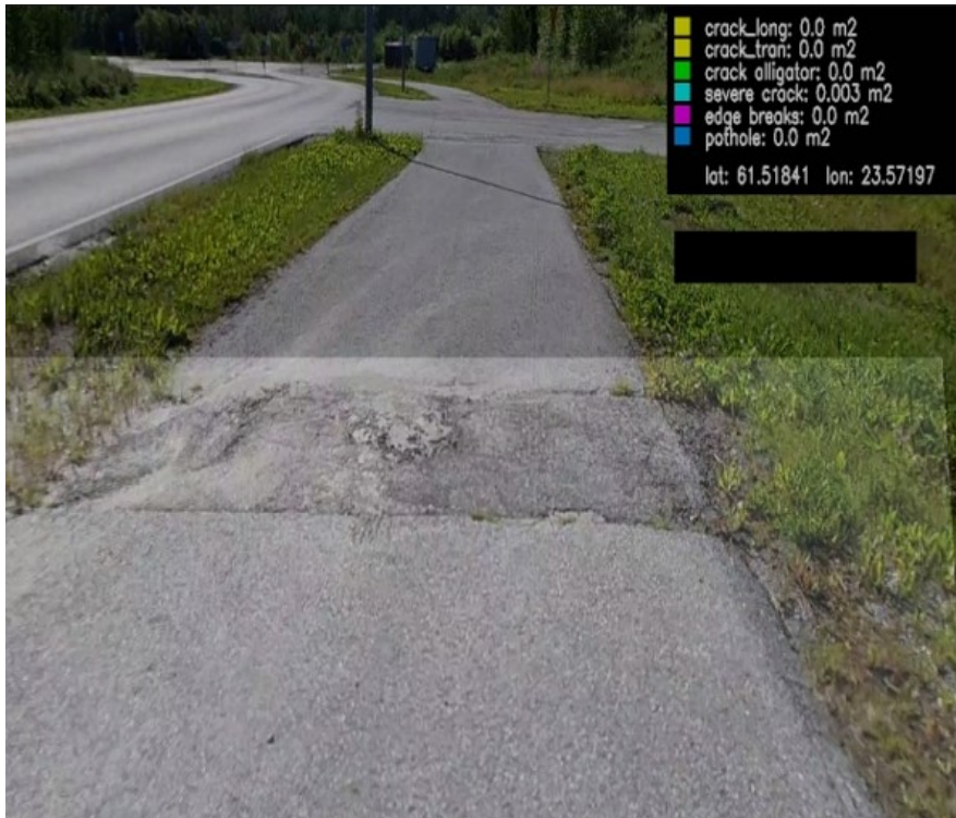
Kuva 34. Huonolaatuisesti tehty paikkaus (AFRY Finland Oy).
