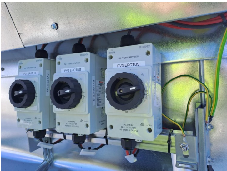
Kuva 35. Tasasähköpuolen turvakytkimet sekä potentiaalintasausjohtimet.
