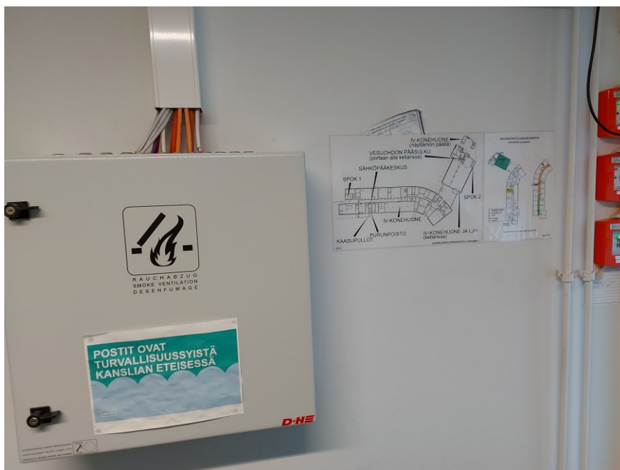
Kuva 32. Kohta, johon aurinkosähköjärjestelmän irtikytkentäpainike sekä kohdekortti tulisi sijoittaa. Kuvassa vasemmalla savunpoistoluukkujen keskus ja oikealla oranssit savunpoistopainikkeet.
