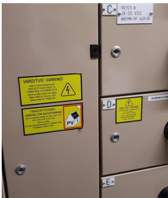
Kuva 36. Aurinkosähköjärjestelmästä varoittavat merkinnät keskuksen kannessa.
