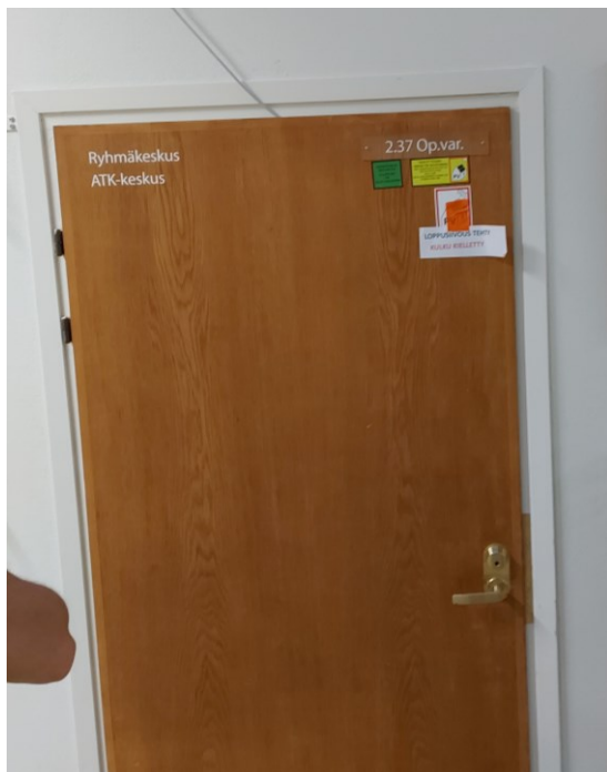
Kuva 37. Aurinkosähköjärjestelmästä varoittavat merkit teknisen tilan ovenssa. Merkit oven oikeassa yläreunassa.
