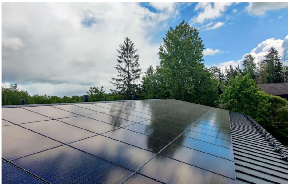
Kuva 12. Asennetut aurinkopaneelit Kivensyrjä 3 rakennuksen katolla. [1.]
