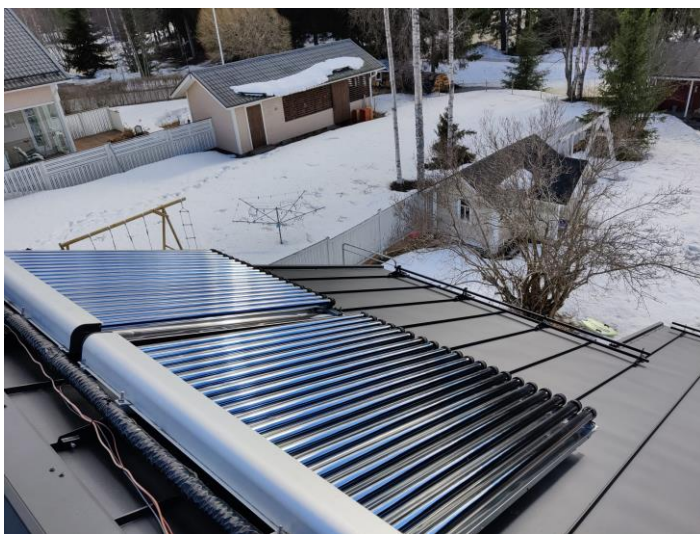
Kuva 4. Tyhjiöputkikeräimet talon eteläpuoleisella katolla.
