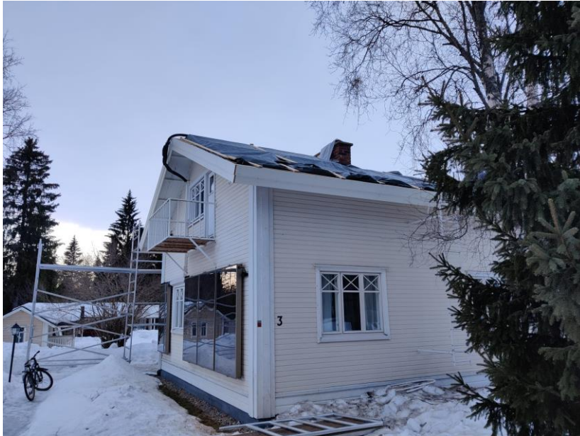
Kuva 5. Tasokeräimet talon päätyseinässä.
