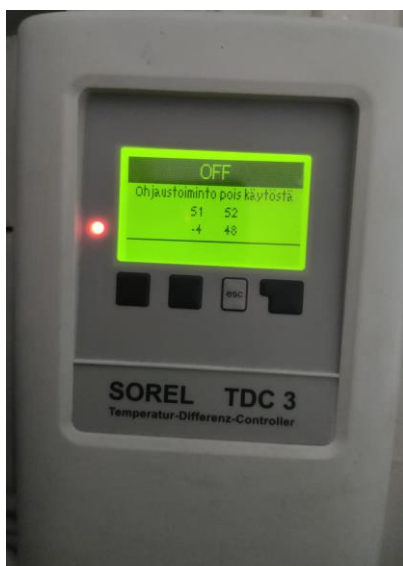
Kuva 6. Aurinkojärjestelmän ohjausyksikkö SOREL TDC 3.
