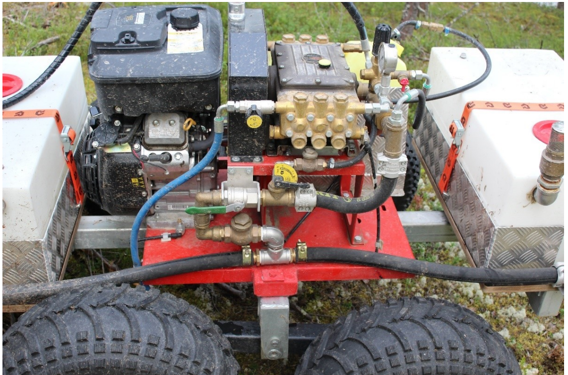
Kuva 3. Prototyypin pumppuyksikkö (Kinnunen 2023)
