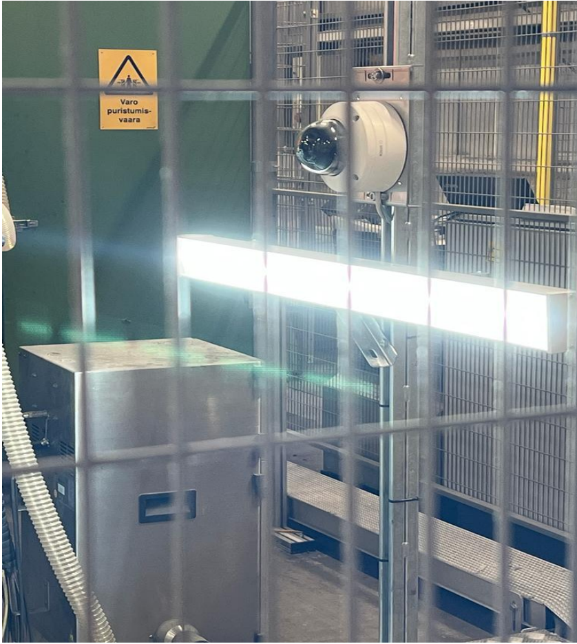
Kuva 6. Kamera ja valo asennettuna
