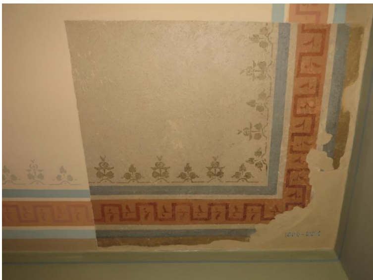
Kuva 76. Parvelle menevän käytävän katon fragmentti.
