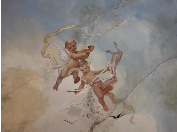
Kuva 20. Putot Juseliuksen talon porrashuoneen katossa.
