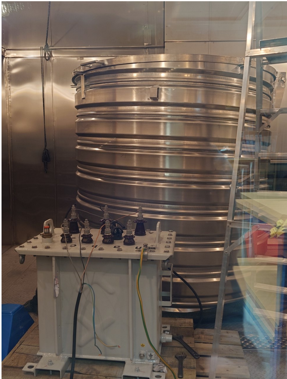
Kuva 24. Säävarma laitesuoja ja kuivamuuntaja lämpenemättestissä. (Atte Saarni 2023)
