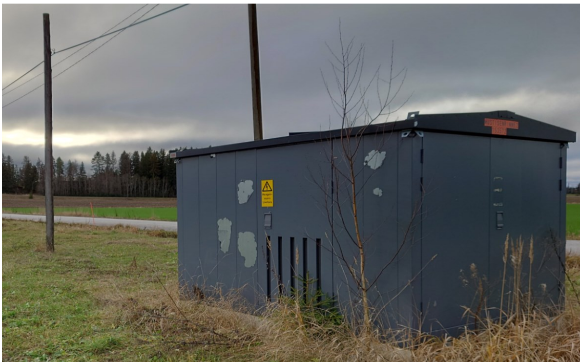
Kuva 3. Säävarman maakaapeloidun järjestelmän puistomuuntamo. (Atte Saarni 2022)
