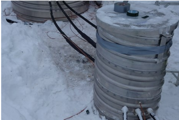
Kuva 11. Säävarma mittaussuoja ja kompensointireaktori kaapelointi. (Atte Saarni 2022)
