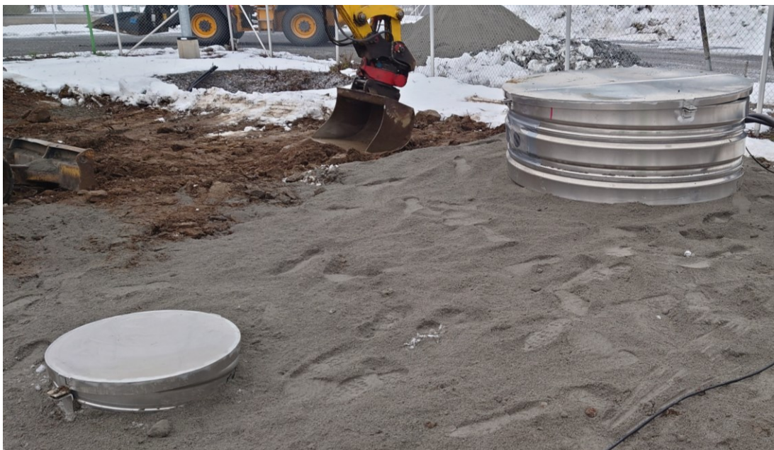
Kuva 12. Säävarma mittaussuoja ja laitesuojassa kompensointireaktori asennettuna, asennustapa A. (Atte Saarni 2023)
