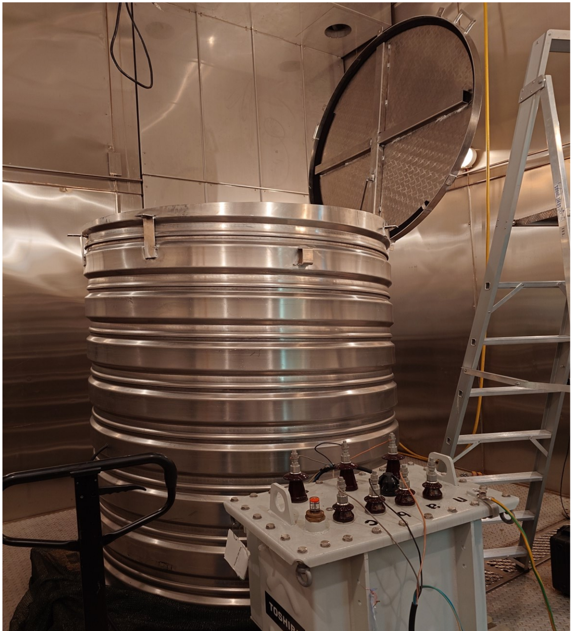
Kuva 23. Säävarma laitesuoja 50 KVA kuivamuuntaja sisällään. Etualalla 1/0,4 KV testimuuntaja. (Atte Saarni 2023)
