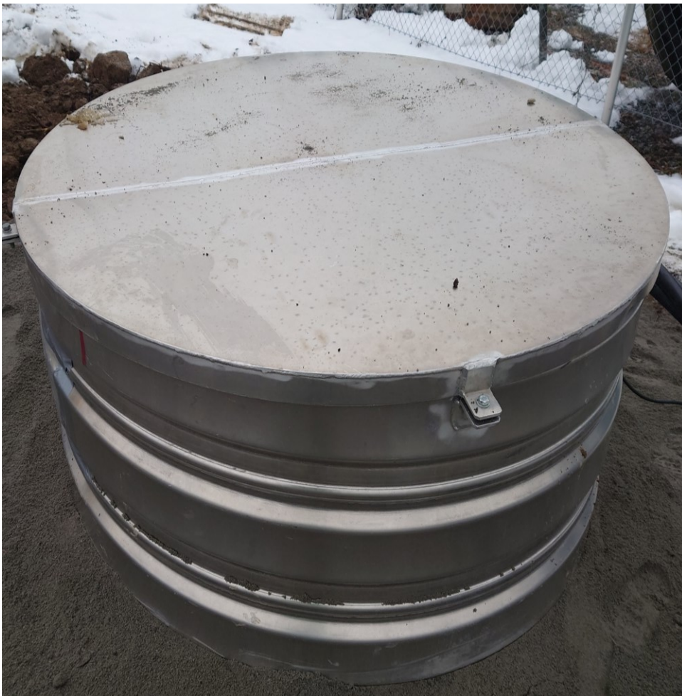
Kuva 17. Säävarma laitesuoja ja kompensointireaktori asennettuna Sähkökentällä, asennustapa A. (Atte Saarni 2023)
