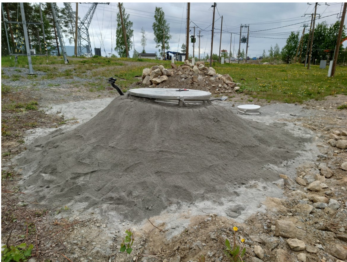
Kuva 18. Säävarma laitesuoja ja kompensointireaktori asennettuna Sähkökentällä, asennustapa B. (Atte Saarni 2023)
