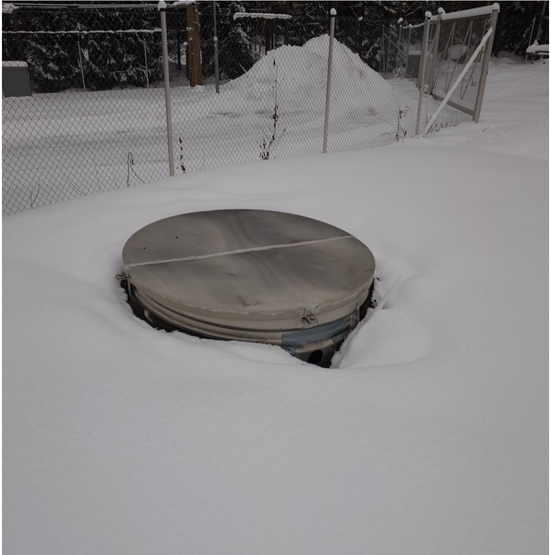
Kuva 20. Säävarma laitesuoja asennustapa C. Kuva otettu 14.12.2023. (Atte Saarni 2023)
