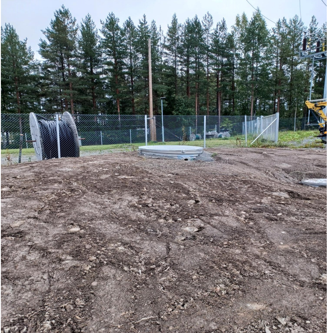
Kuva 19. Säävarma laitesuoja ja kompensointireaktori asennettuna Sähkökentällä, asennustapa C. (Atte Saarni 2023)
