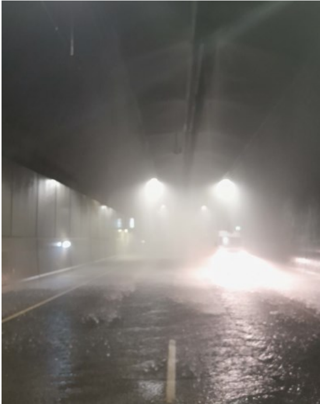
Kuva 4. Tunnelin automaattisen sammutusjärjestelmän tarkastaminen (tarkastusyksikön sisäinen aineisto, n.d.)
