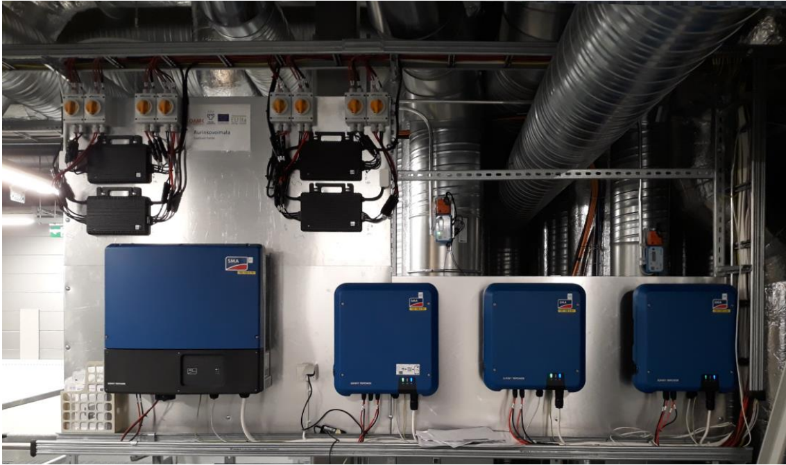
KUVA 10. SMA Sunny Tripower invertterejä. Vasemmalta oikealle 15 kW, 10 kW, 3kW ja 3kW (OAMK 2020)
