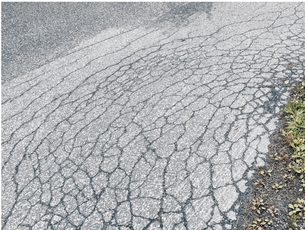
KUVA 2. Tyypikuva: verkkohalkeama (Kalle-Pekka Kolehmainen 2023).
