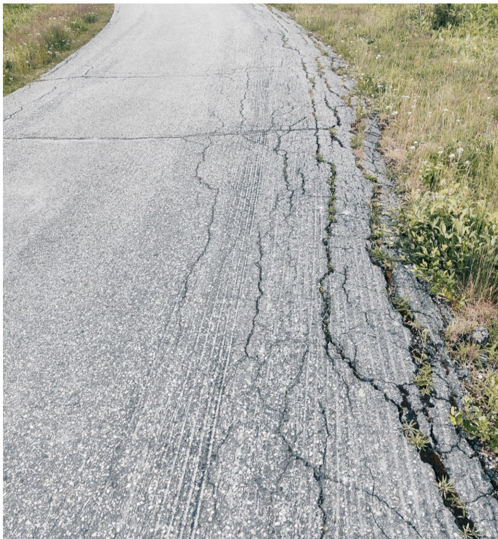
KUVA 5. Tyyppikuva: Rakenteellinen puute, reunapainuma (Kalle-Pekka Kolehmainen 2023).
