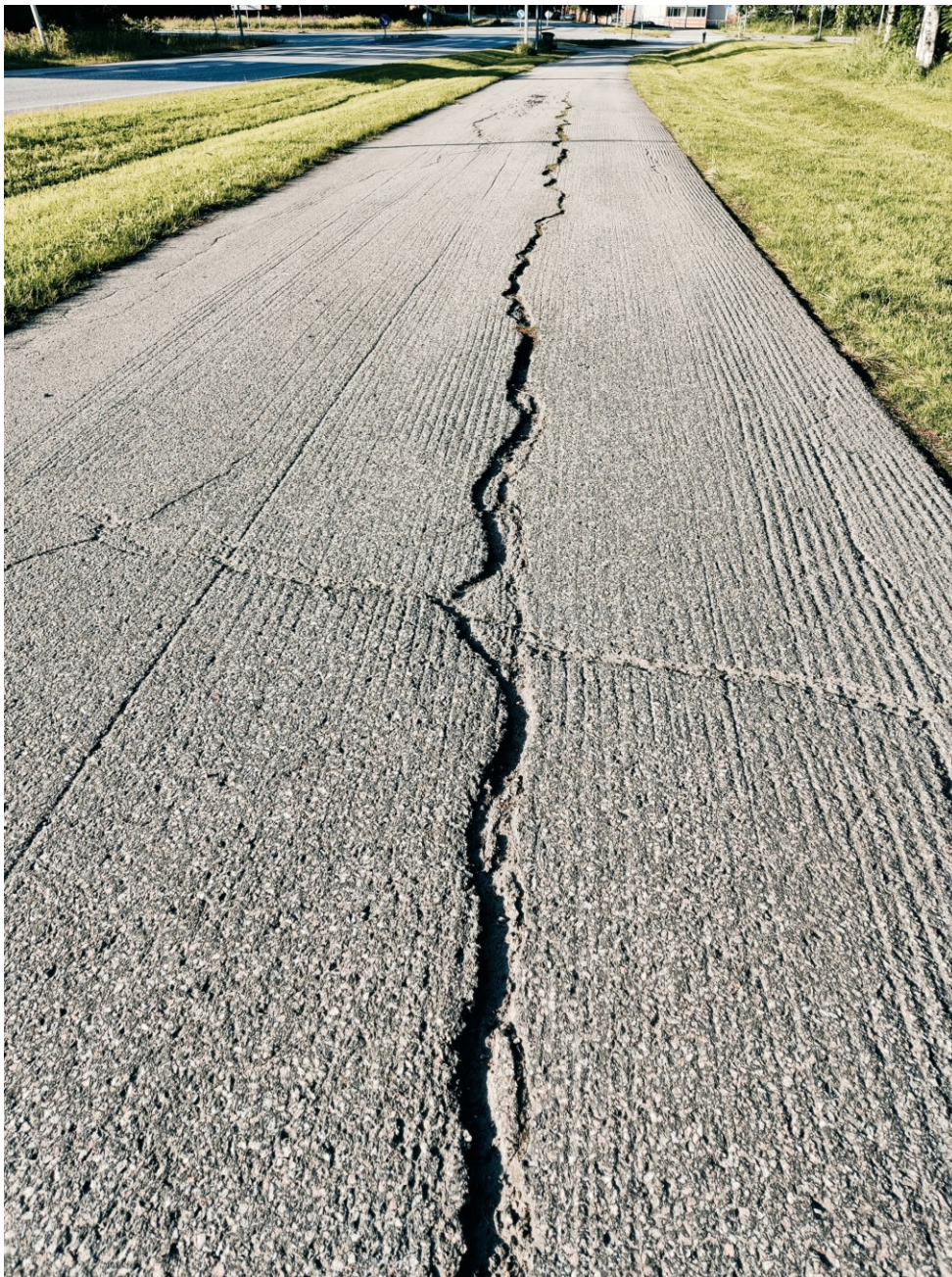
KUVA 1. Tyypikuva: halkeama, pituussuuntainen halkeama (Kalle-Pekka Ko- lehmainen 2023).
