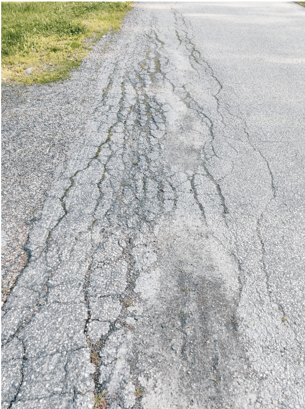
KUVA 9. Huono/ erittäin huono kuntoluokka eli kuntoluokka 3 (Kalle-Pekka Kolehmainen 2023).
