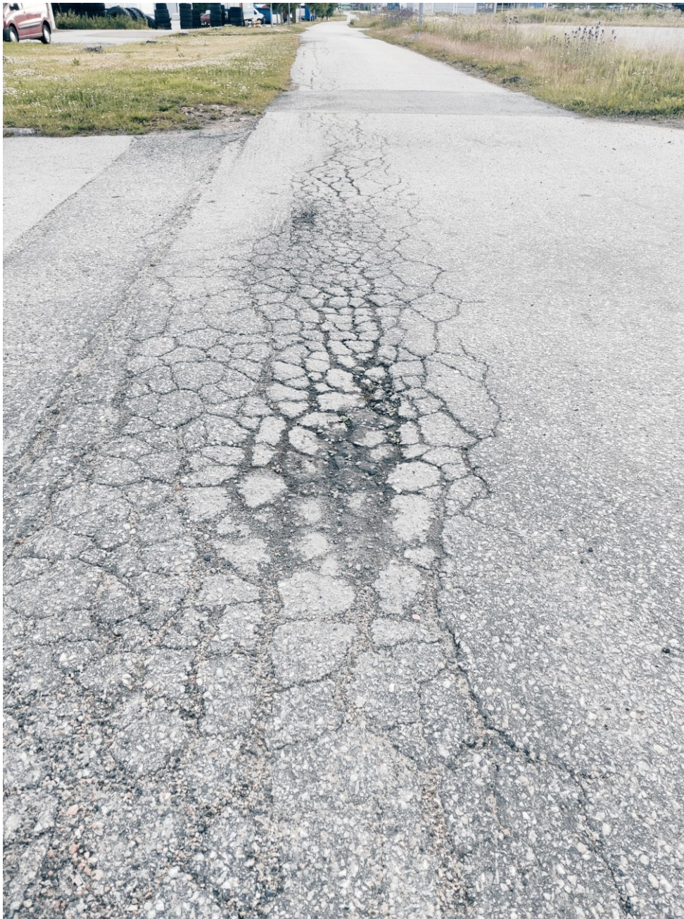
Laaja verkkohalkeama, Nuaskadulla lähellä VT5:lle kääntyvää risteystä.
