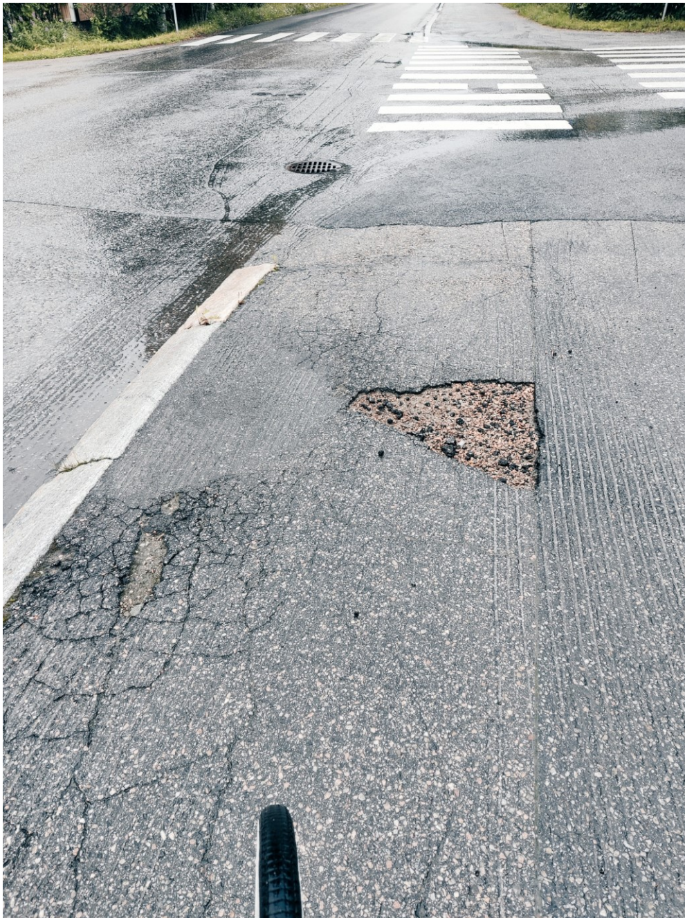
Purkauma keskellä väylää sekä verkkohalkeamaa, Lehtikankaantien ja Käpykadun risteys.
