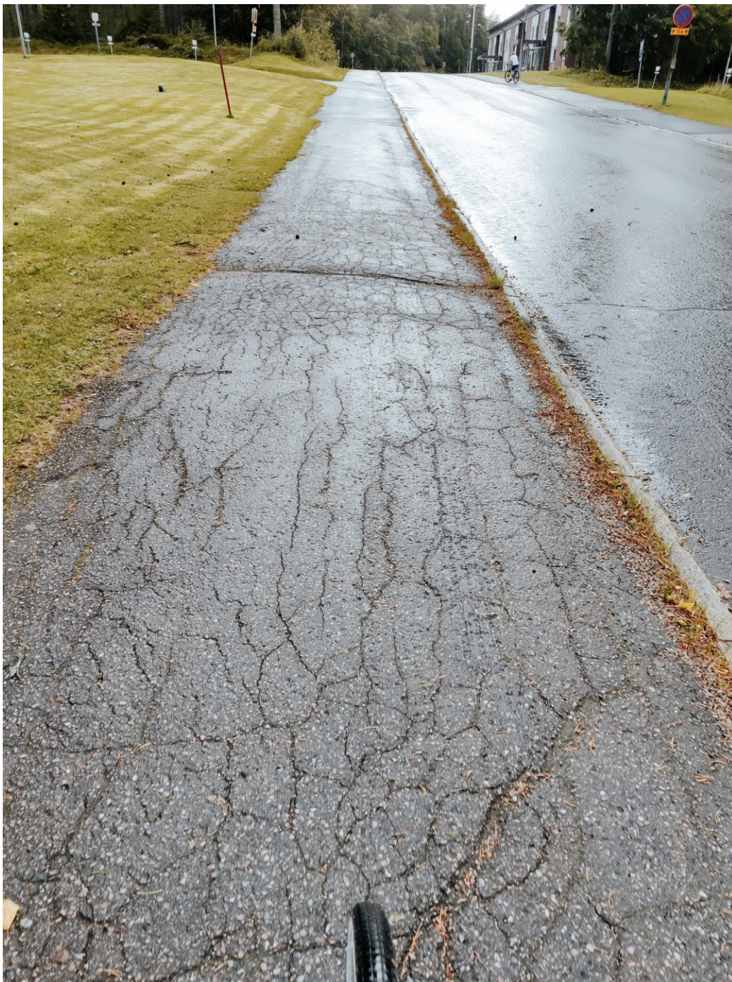
Iso verkkohalkeama ja epätasaisuutta/ routanousua. Ketunpolulla lähellä Kajain ammattikorkeakoulun Taito 1/ Tieto 1- rakennuksia.
