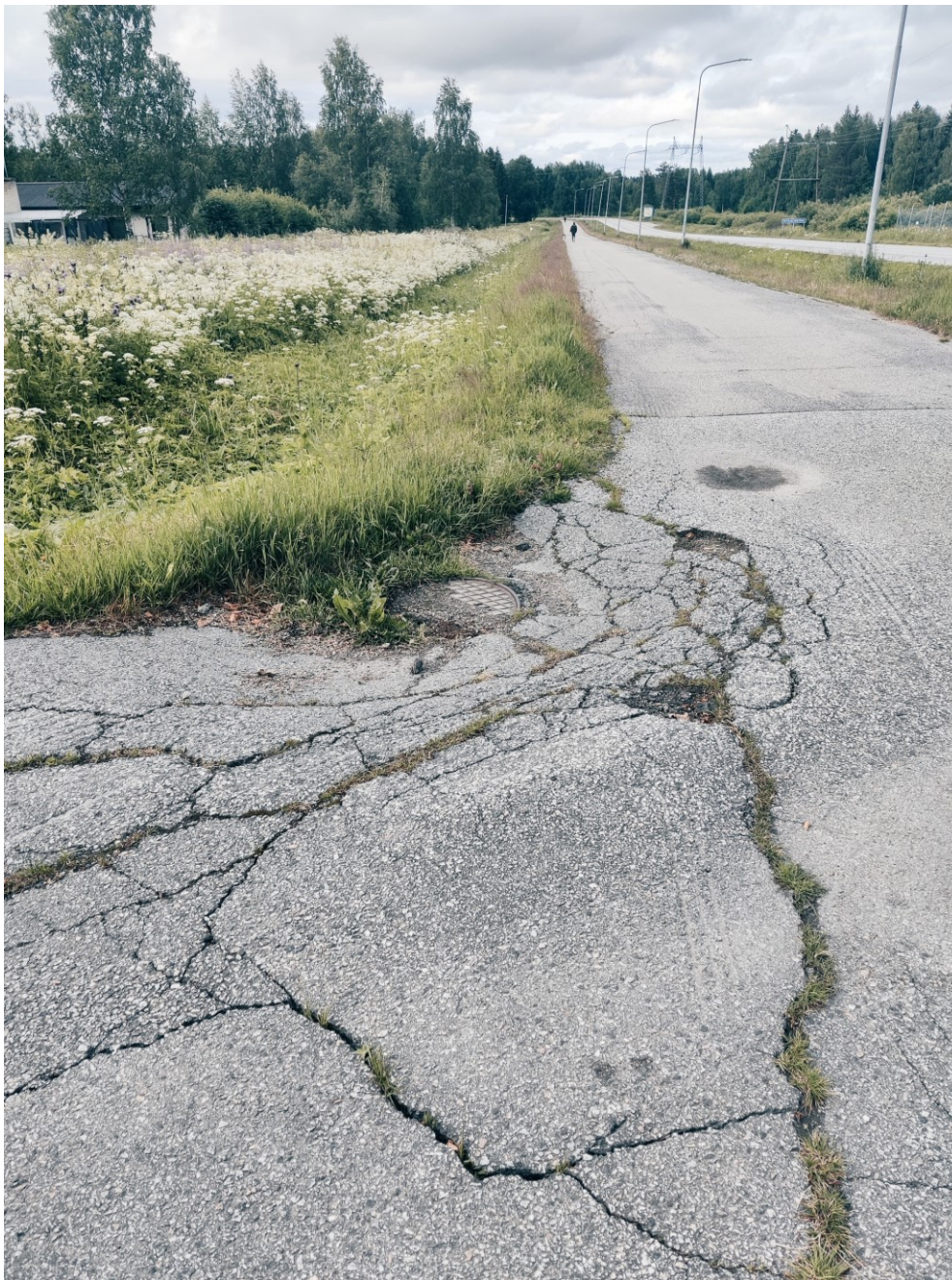
KUVA 16. Laaja verkkohalkeama ja routanousu. Kehräämöntiellä Kuovikujan risteyksessä.
