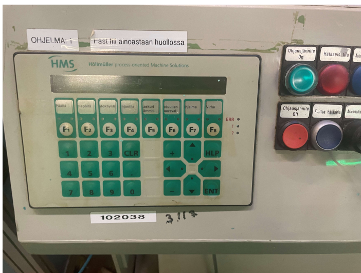
KUVA 9. Vanha käyttöliittymä linjan alussa
