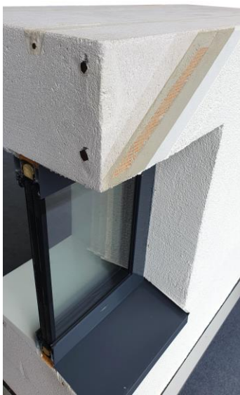
KUVA 3. Ikkuna asennettuna yksiaineiseen kevytbetonirakenteeseen. Raudoitettun aukonylityspalkin ulkopinnassa näkyvät myös rappauksen eri kerrokset; pohjustusaine, ohutrappaus, kuituverkko sekä pintarappaus. (Kuva: Helmi Mäki-Latvala 2023)
