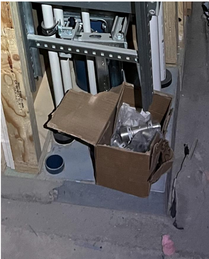
Kuva 14 Palokatkon yläpuoli tekniikka hormissa
