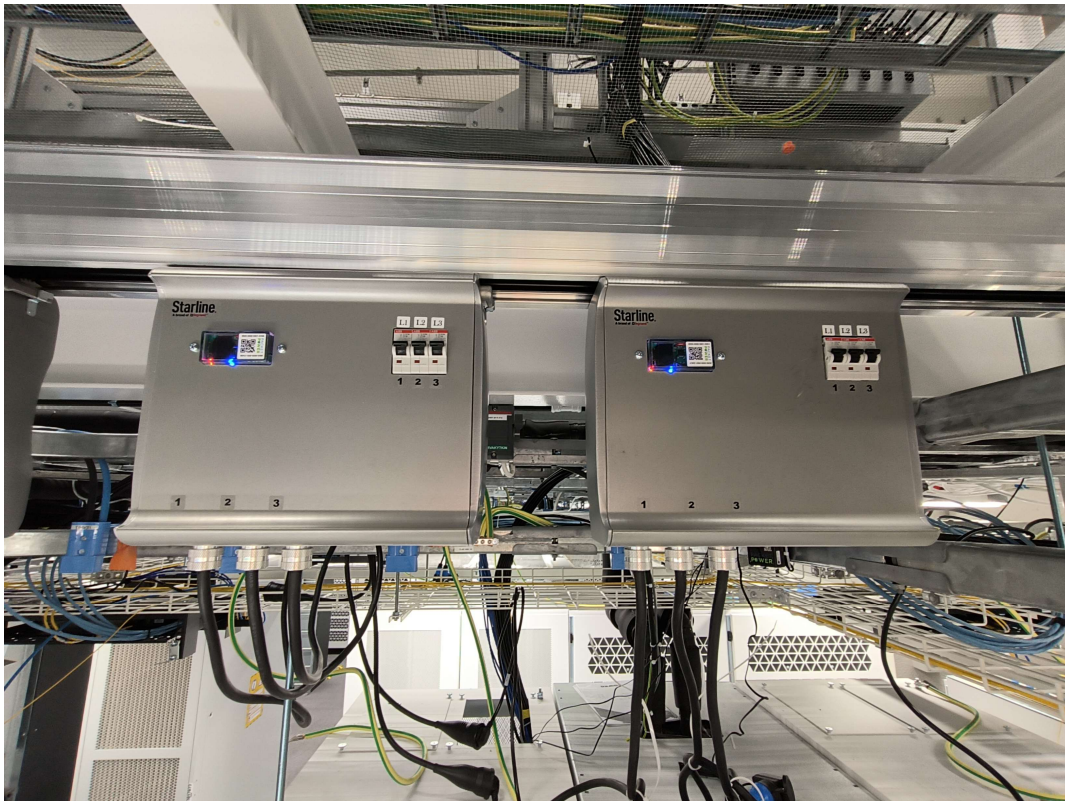
Kuva 14. Starline-virranottimet joissa packetpower-mittari
