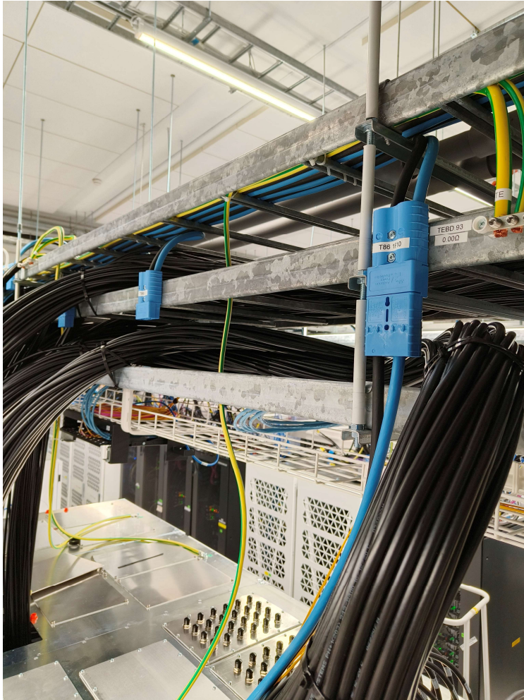
Kuva 6. Andersson-liittimiä kaapelihyllyn reunassa
