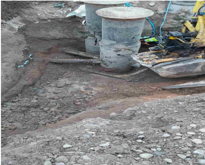
Kuva 16. Kuvassa jätevesi, hulevesi ja vesijohtoliitokset [8.]
