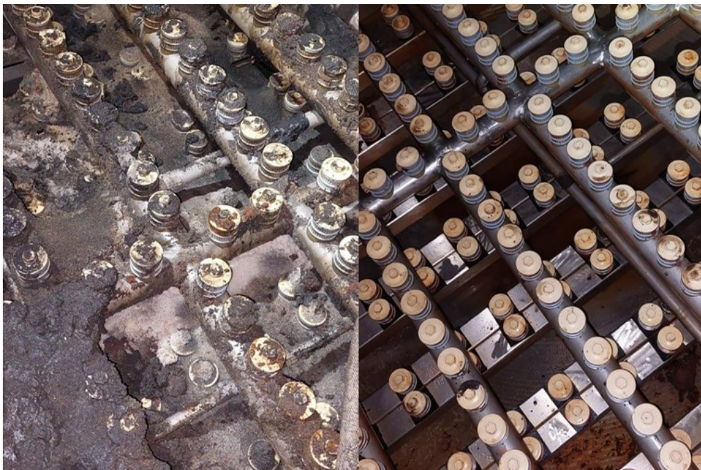
Kuva 26. Hiekkasuodattimen suuttimet ennen ja jälkeen tarkastuksen. Hiekkasuodattimien hiekka vaihdettiin viimeksi vuosihuollossa 2022, jolloin hiekka oli hyvin likaista. Tuhkaa oli päätynyt normaalia enemmän pesuriin letkusuodattimen pölyvuodon vuoksi.
