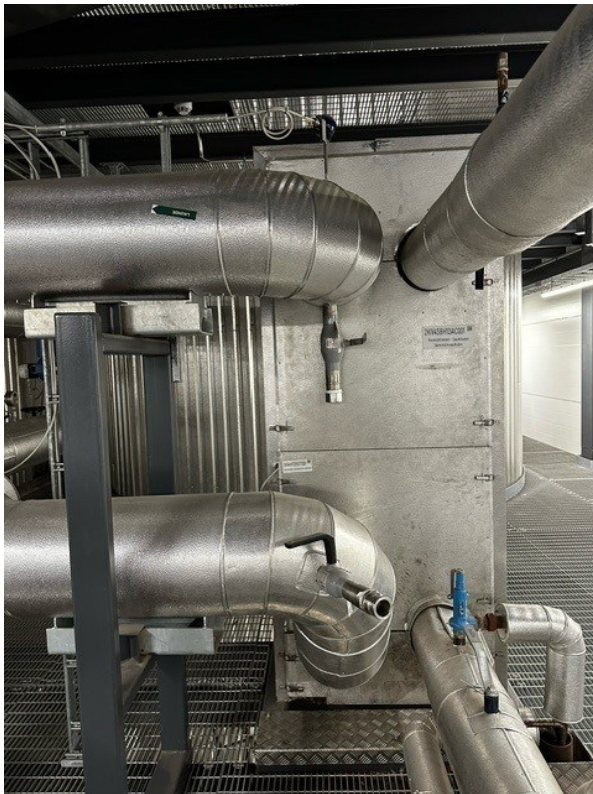
Kuva 29. Kostuttimen lauhteen lämmönvaihdin 2KIV4SBH12AC001.
