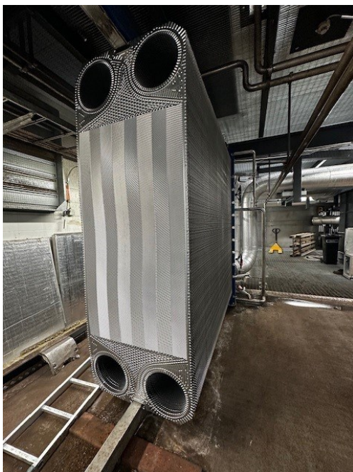
Kuva 50. LTO-lämmönvaihtimen saatiin uusi levypakka 28.11.2023.
