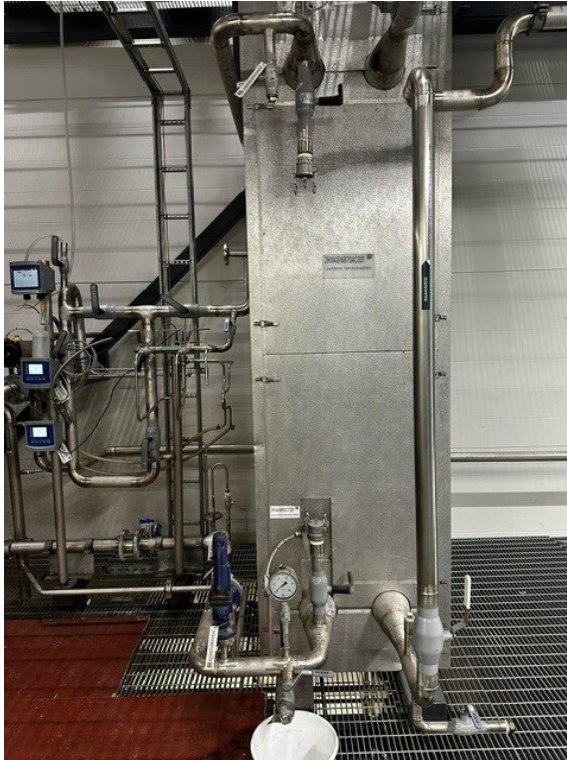
Kuva 30. Lauhteen lämmönvaihdin 2KIV4GNB70AC001.
