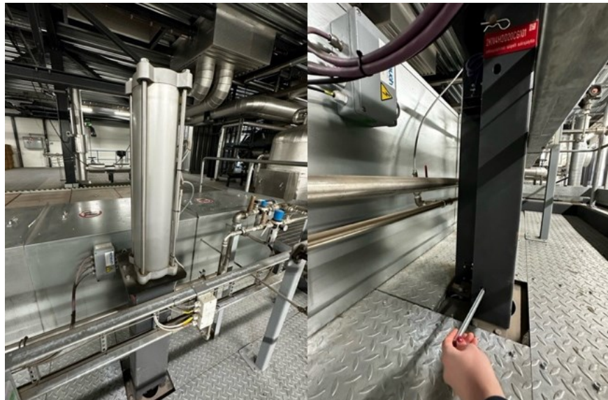
Kuva 44. Puhtaan puolen pelti lukitaan paikalta löytyvällä kierretankopätkällä.
