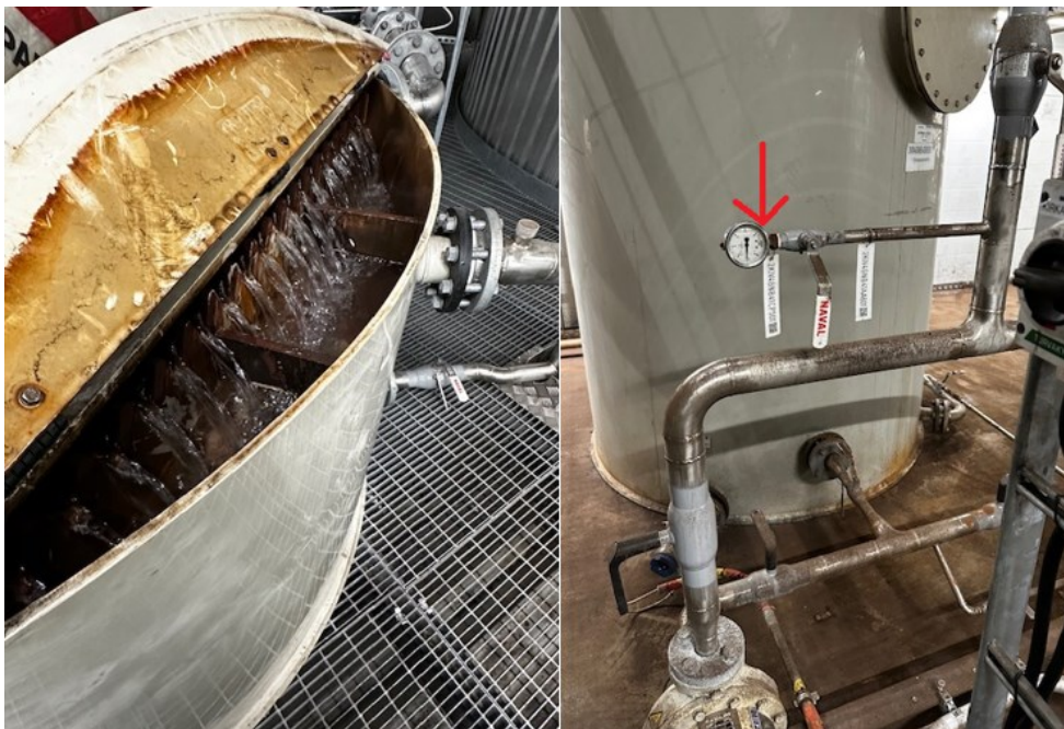
Kuva 53. Näyte ennen lamelliselkeytintä voidaan ottaa saostussäiliöstä ja näyte lamelliselkeyttimen jälkeen kirkastepumpun jälkeisestä painemittarin yhteestä.
