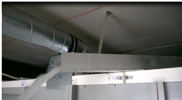
Kuva 22. Asennustilaan poratusta reiästä purkautuu kymmeniä litroja vettä.
