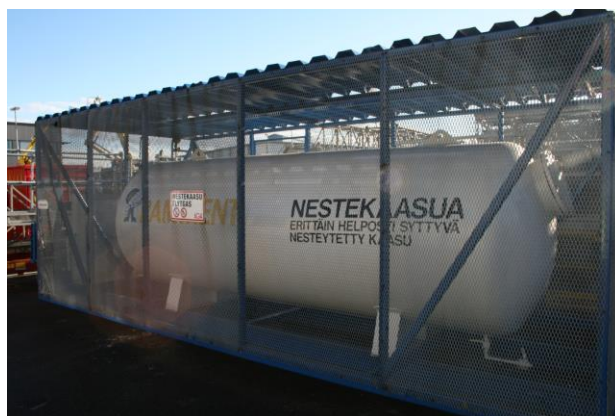
Kuva 6. 3200 kilon kaasusäiliö lukittavassa kehikossa.
