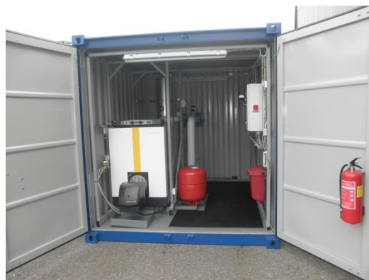
Kuva 12. Merikonttiin rakennettu lämpökeskus.
