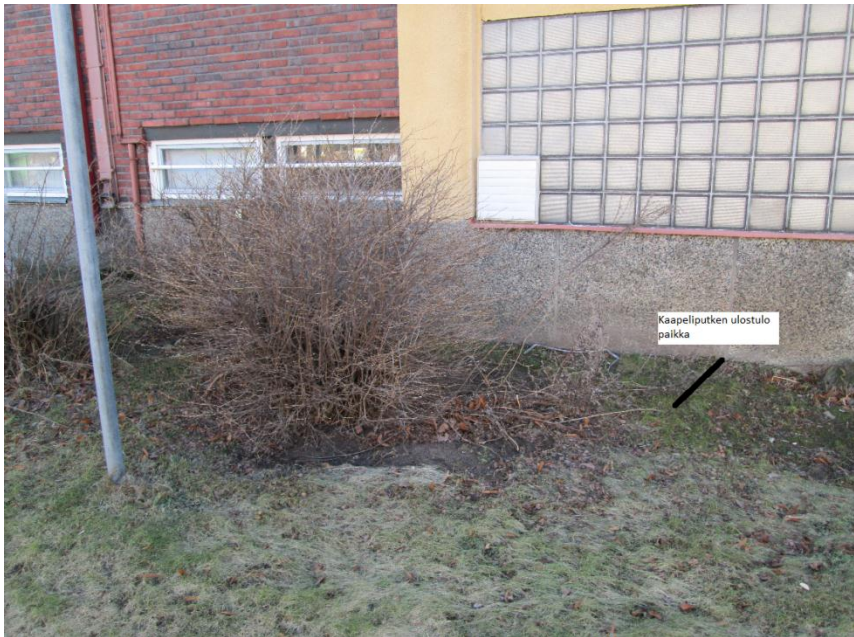
Kuva 13. Kaapelin rakennukseen sisäänmeno paikka.
