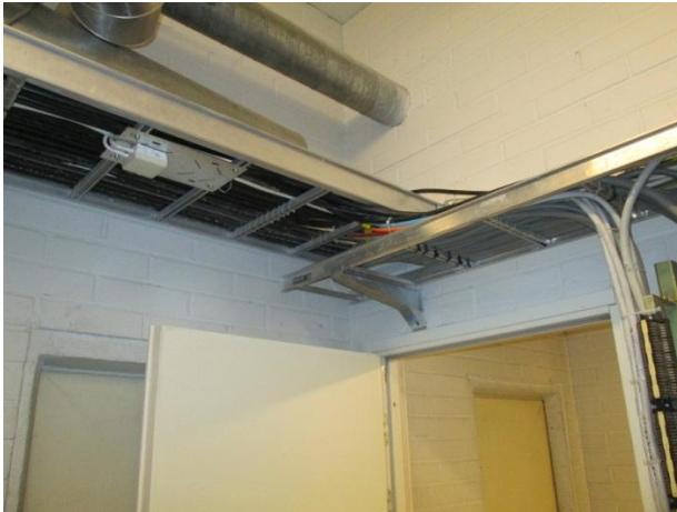
Kuva 16. Kaapeli kääntyy oikealle lähtevälle hyllylle.
