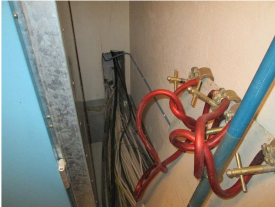
Kuva 18. Kaapeli laskeutuu muuntamotilan lattialle huoneen nurkassa.
