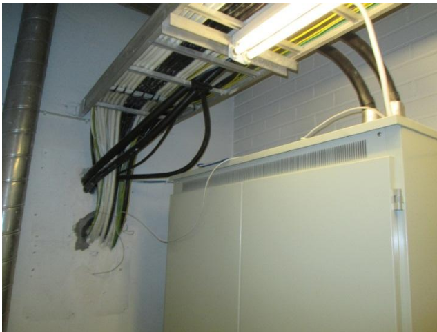
Kuva 17. Kaapeli laskeutuu hyllyltä ja menee muuntamotilaan.
