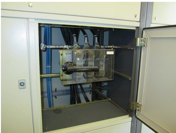
Kuva 9. Vapaana oleva liityntäpiste sijaitsee keskuksessa hitaanlatauksen aseman liitynnän vieressä.
