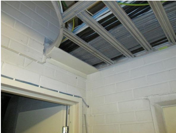
Kuva 15. Kaapeli menee hyllyä pitkin seuraavaan huoneeseen.
