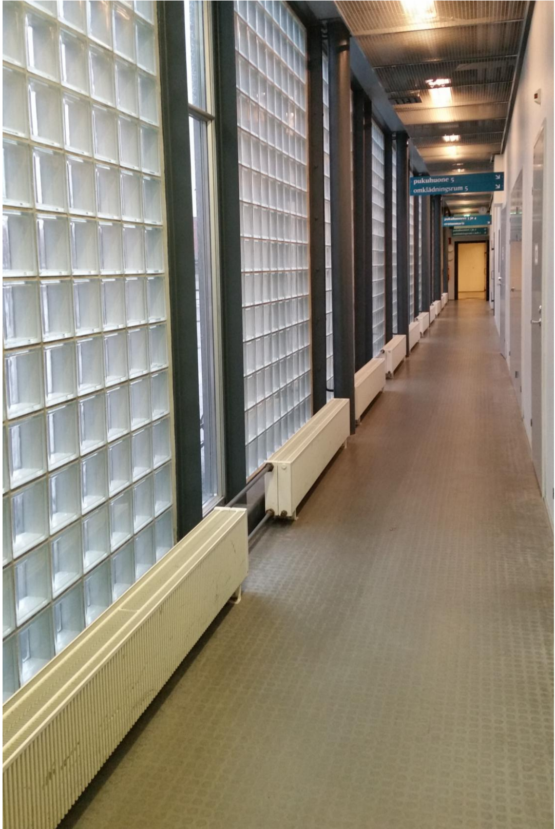
Kuva 6. Herttoniemenrannassa käytävälle sijoitetut patterit tekevät tilasta vaikean siivota. Yleisö myös käyttää matalia pattereita penkkeinä, mikä vaurioittaa putkia. Kuva Sari Tamminen.
