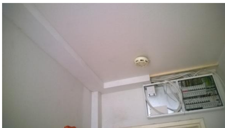
Kuva 36. Uusi sähkökeskus sekä pintakäsittely kotelointi [35]
