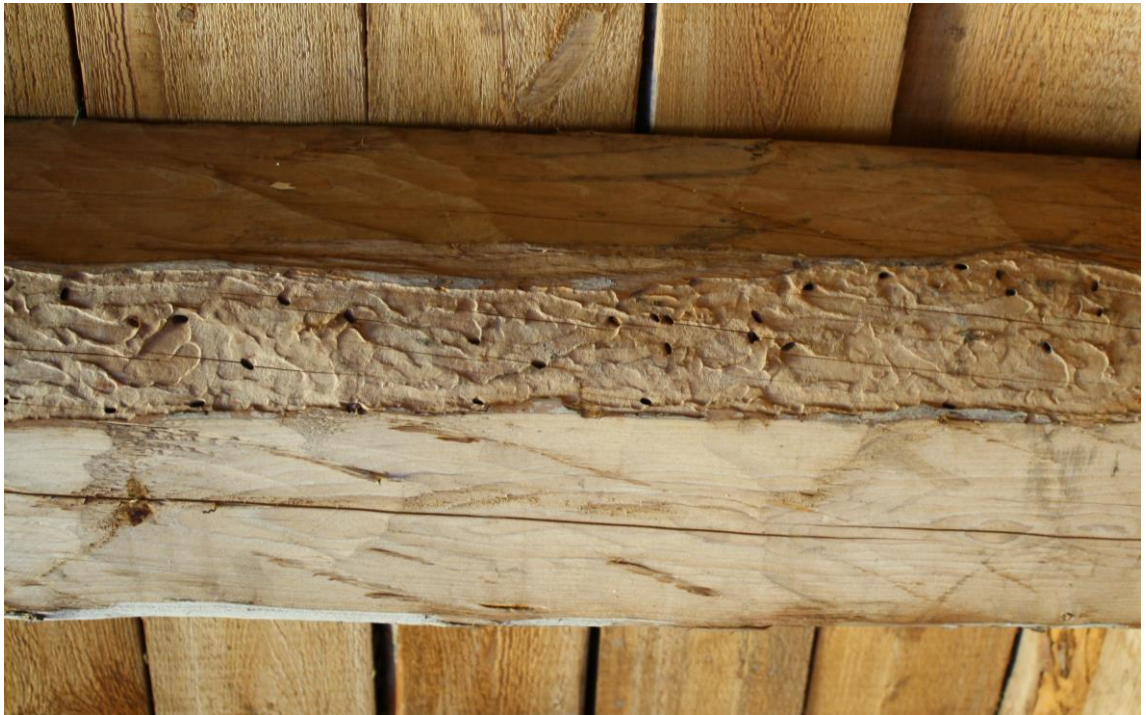
Kuva 11. Näyttelytilan välikaton kannattajassa on tuohyönteisten jättämiä jälkiä (Malmi 2014)
