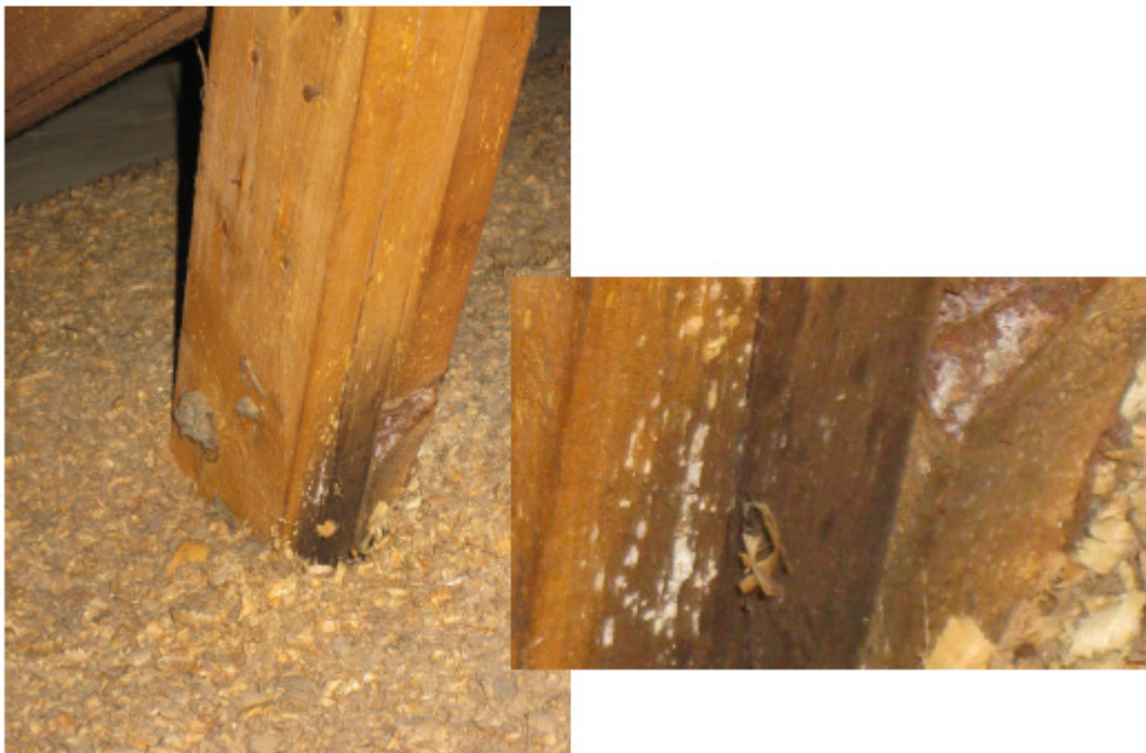
KUVA 12. Tummunut kattotuoli, jossa homekasvustoa
