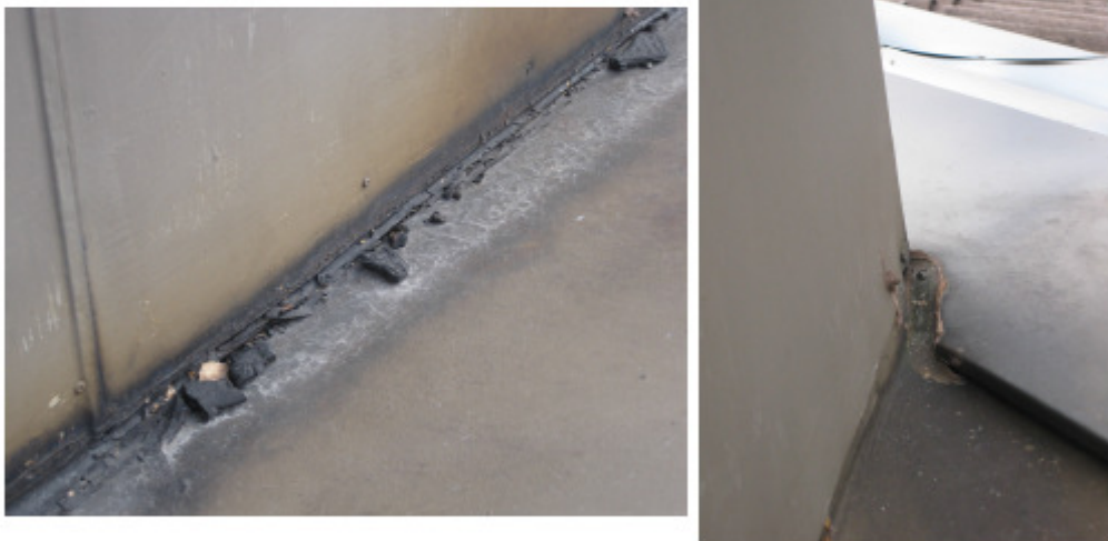
KUVA 15. Piipun pellityksen juuren tiivistysmassaus on lohkeillut. Auman pellityksen ja piipun juuren välinen liitoskohta vaikuttaa epätiiviltä, mekaaniset kiinnikkeet, esimerkiksi kateruuvit, uupuvat.
