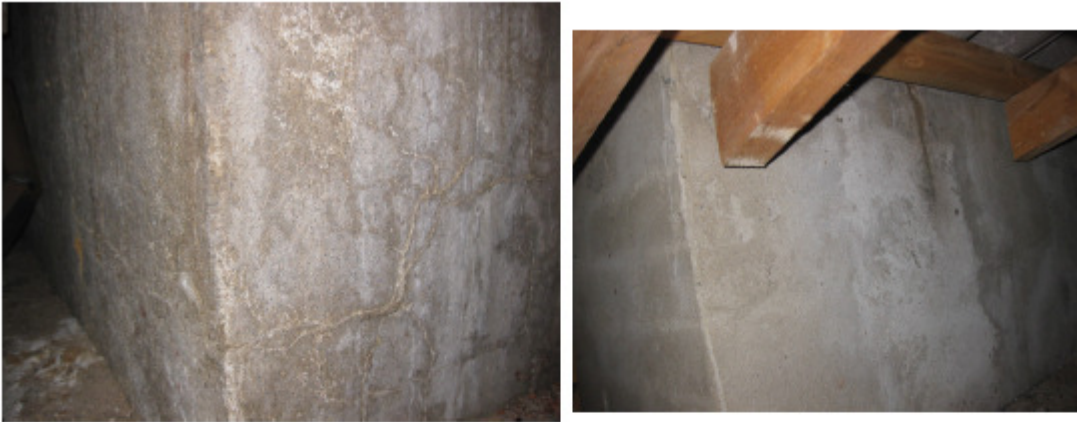
KUVA 11. Rapautuma- ja vuotojälkiä piipun kyljissä
