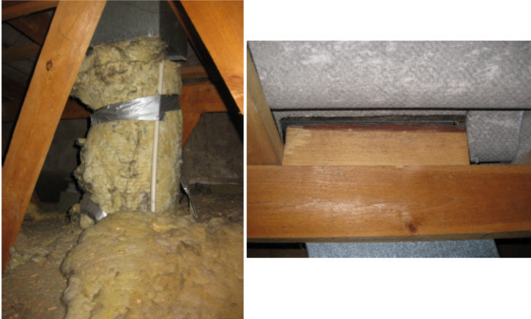
KUVA 8. Ilmastointiputken eristys ja sen terve juuriosa
