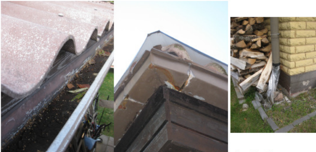
KUVA 19. Sadevesikourut kaipaavat puhdistusta ja kourun kulmat vuotavat. Alastulojen ohjaus muovin avulla sadevesikaivoihin.
