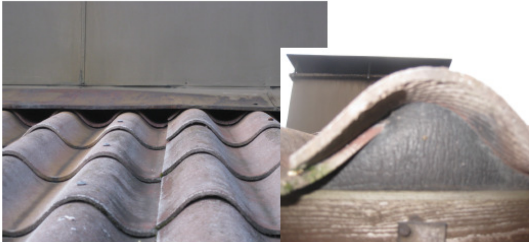
KUVA 14. Piipun juuresta uupuu tiiviste, mutta tiiviste on asennettu oikeaoppisesti räystäälle
