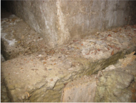
KUVA 9. Palovilla oli piipun juuresta täysin kostea ja kyljissä havaittavissa rapautumista.
