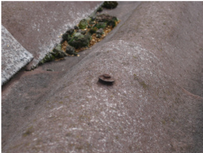
KUVA 18. Katossa ruostuneita nautoja
