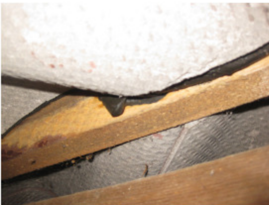
KUVA 5. Tiivistettä on paikoitellen reilusti aumakohdissa
