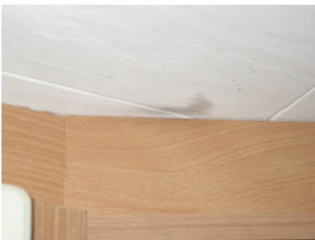
KUVA 3. Tummentuma keittiön katossa liesituulettimen läheisyydessä
