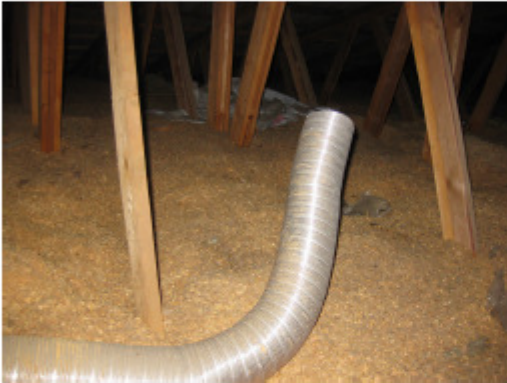
KUVA 2. Liesituulettimen eristämätön poistoputki jää yläpohjaan
