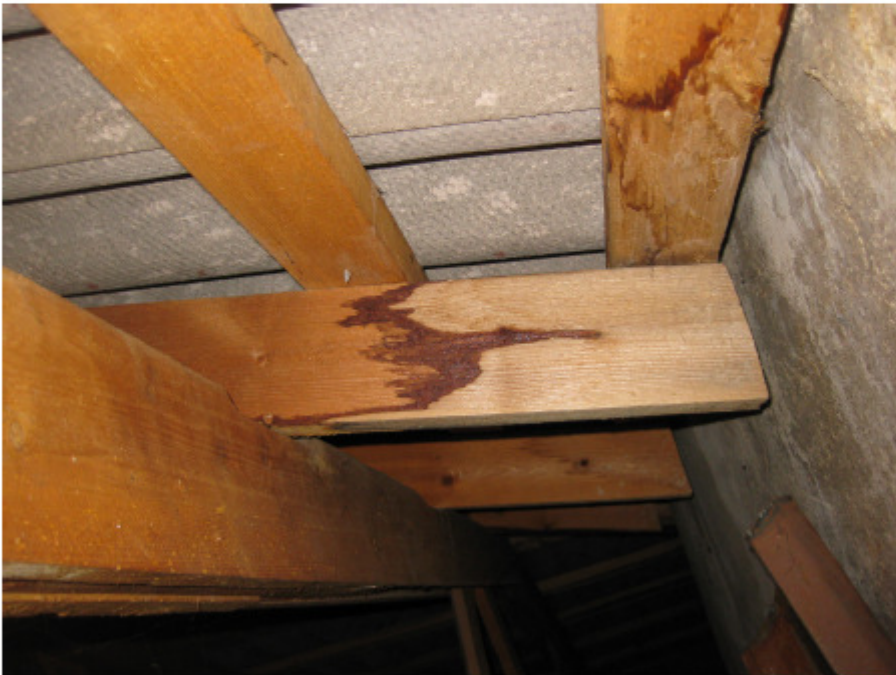
KUVA 10. Kattokannattajissa ja ruodelaudoissa selkeitä jälkiä kosteudesta
