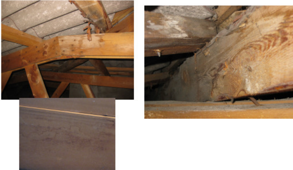
KUVA 13. Piippupäädyssä olevia tummuneita kattorakenteita, joissa merkkejä kosteusrasituksesta ja osassa jo silmin nähden havaittavaa kasvustoa. Vuotojälkiä havaittavissa myös pannuhuoneen sisäkatossa.
