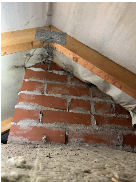
KUVA 27. Savupiipun läpiviennissä aluskatteen asennuksessa puutetta.
