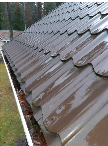
23. Vesikattoa, sadevesikouruissa puhdistustarvetta
