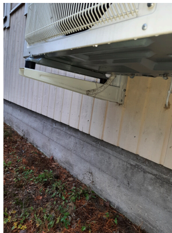
68. Ilmalämpöpumpun ulkoyksikkö, kondenssivesien poisjohto
