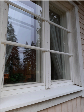
18. Ikkunaa, maalipinnassa vauriota
