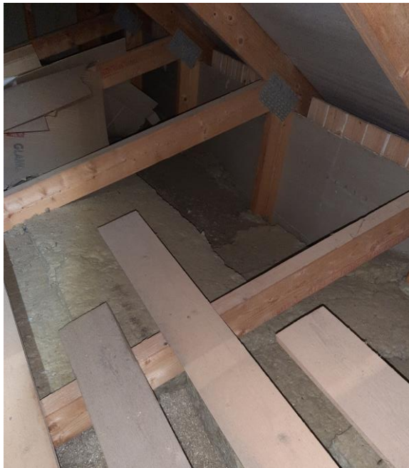
KUVA 28. Yläpohjan epätasaisesti asennettua lämmöneristystä sekä räystäätuuletusta.
