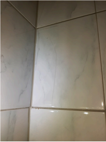
51. Vähäinen laattahalkeama, ei toimenpiteitä
