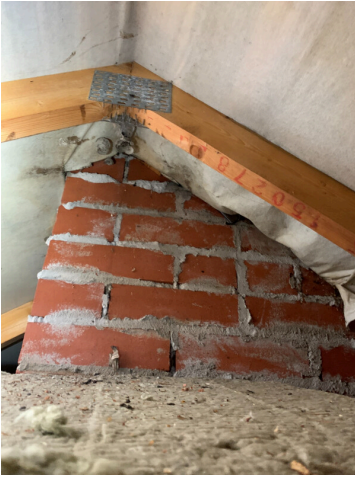
44. Savupiippu. Aluskatteen asennuksessa epätiiveyttä läpiviennissä
