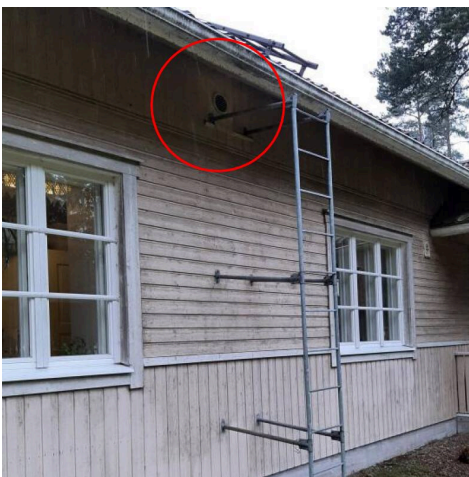
42. Ilmanvaihtokoneen poistoilmakanavasäleikön sijainti
