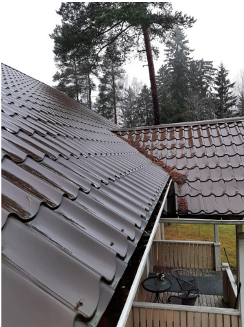
27. Vesikattoa, kattojiirissä puhdistustarvetta
