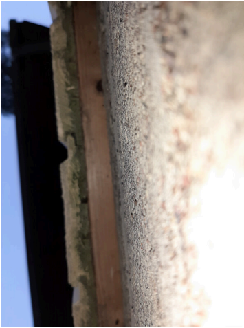
16. Puuverhouksen takana on vaakakoolaus, eikä avointa tuuletusväliä verhouksen takana
