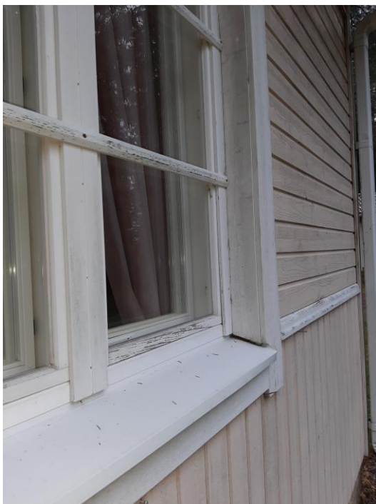
KUVA 26. Vesipeltiä ja ikkunaa, jonka puuosissa maalipinnan vaurioita.
