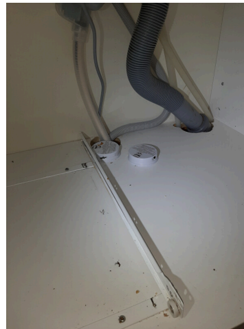
57. Allaskaappia, läpiviennit tiivistämättä
