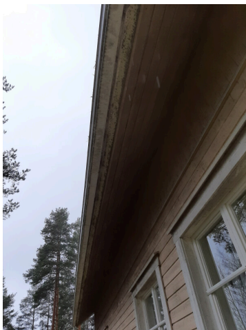
14. Julkisivua, räystäsrakenteissa puhdistustarvetta
