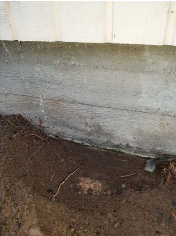
3. Perusmuurin vedeneristeestä ei havaintoa
