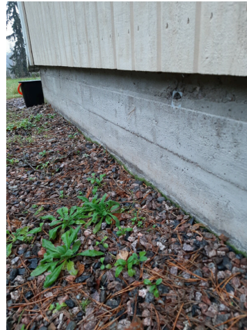
2. Maanrajassa vähäistä kosteusjälkeä
