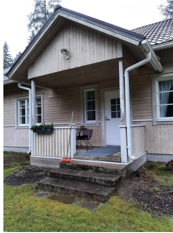
17. Terassia, maalipinnan vaurioita
