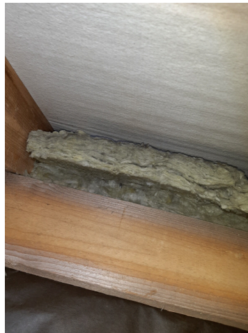
37. Vinon yläpohjan tuuletusväliä pieneltä osin puutetta
