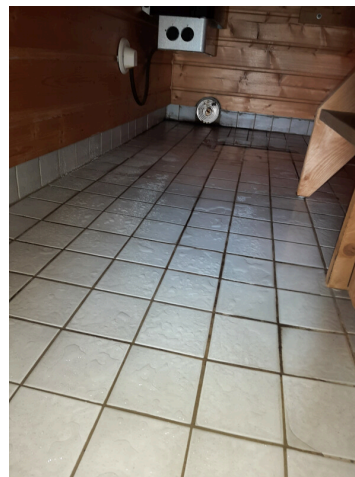
50. Saunan lattiakallistuksessa puutetta, vesi lammikoituu
