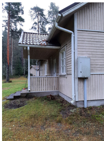
11. Sadevesien poisjohtamisessa puutteita
