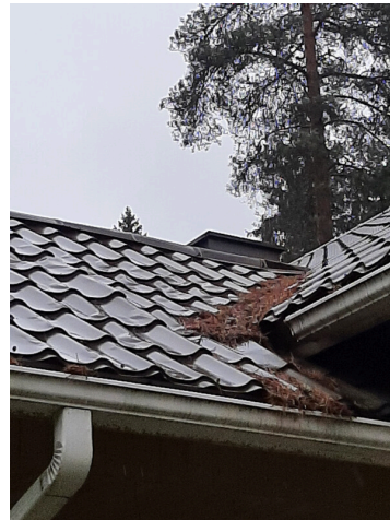
28. Vesikatteessa lommoa terassin kohdalla
