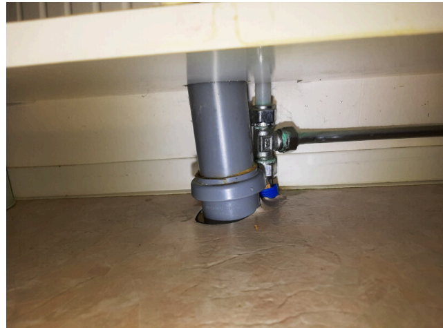
55. Viemärläpiviennissä lattiaan epätiiveyttä, tiivistys
