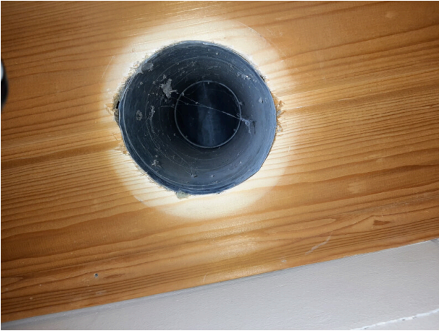
71. Poistoilmakanavassa likaa, nuohous
