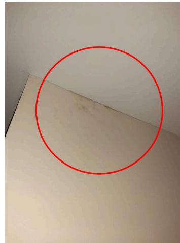
39. Yläkerran varastotiloista katsottuna savupiipun juuresta mahdollista kosteusjälkeä
