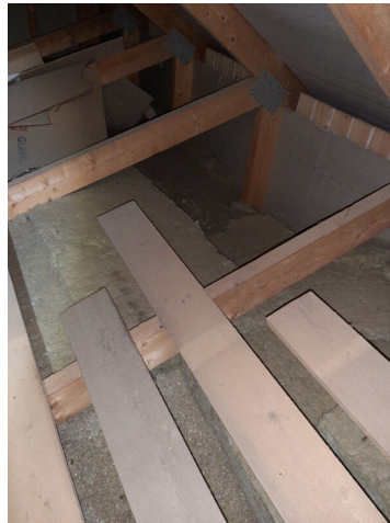
33. Yläpohjatilaa, lämmöneristyksessä paikoin epätasaisuutta
