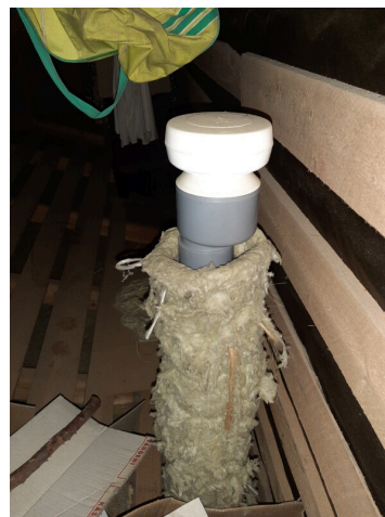
43. Yläpohjatilaan päätetty tuuletusputki, päähän asennettuna alipaineventtiili
