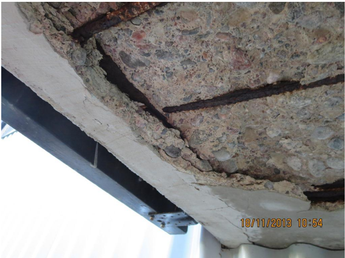
Kuva 2. Huonokuntoinen parvekelaatan pohja
