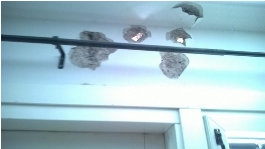
Kuva 26. Olohuoneen seinä johon porattiin vahingossa reikiä puukkokonsolia asennettaessa
