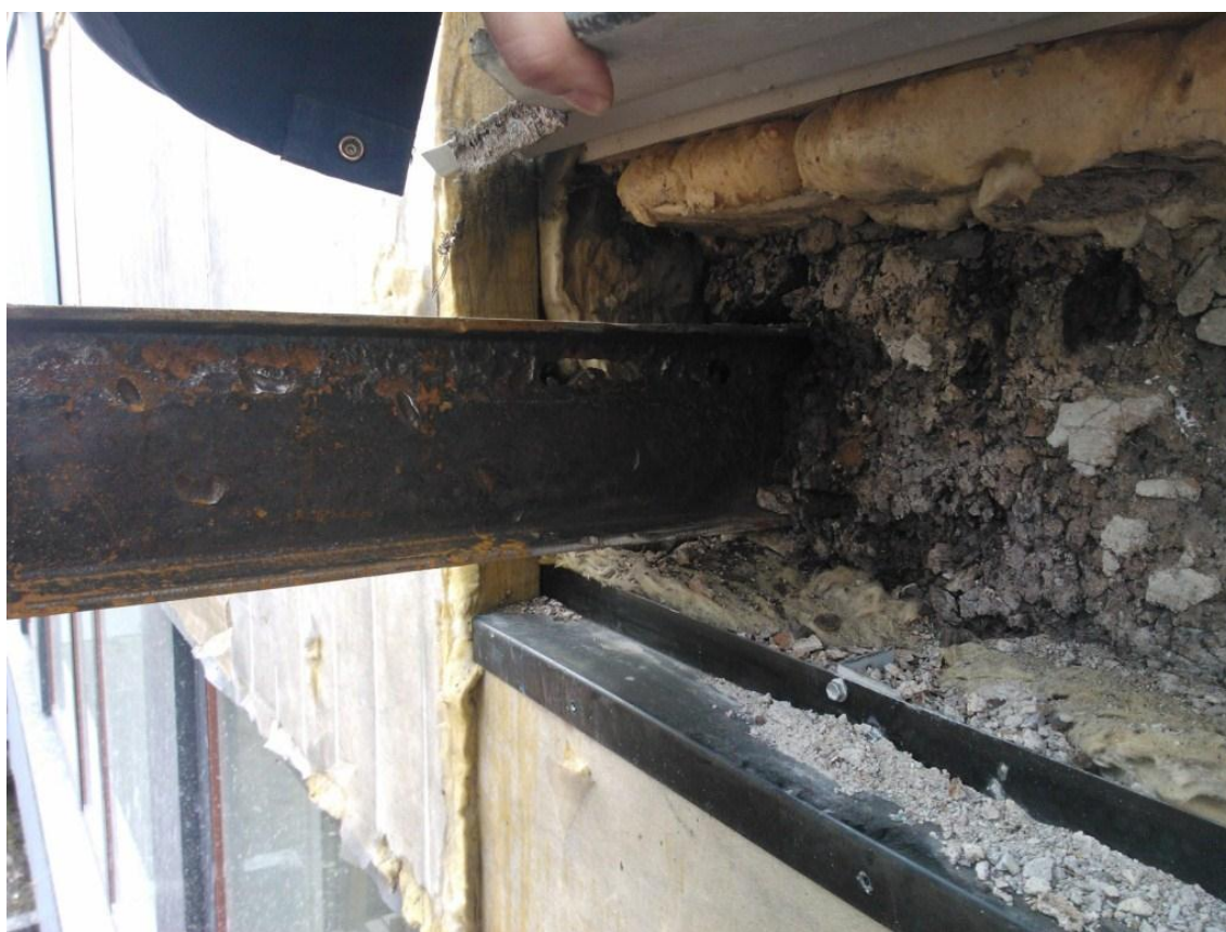
Kuva 24. Parveke-puukko oli läpiruostunut
