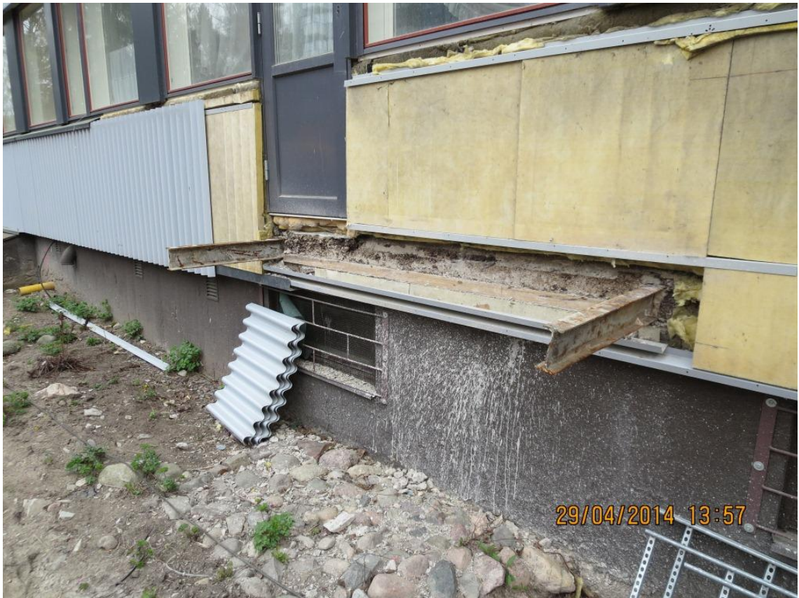
Kuva 11. Kuva parvekepuukoista ennen jatkamista ja ruosteenestokäsittelyä
