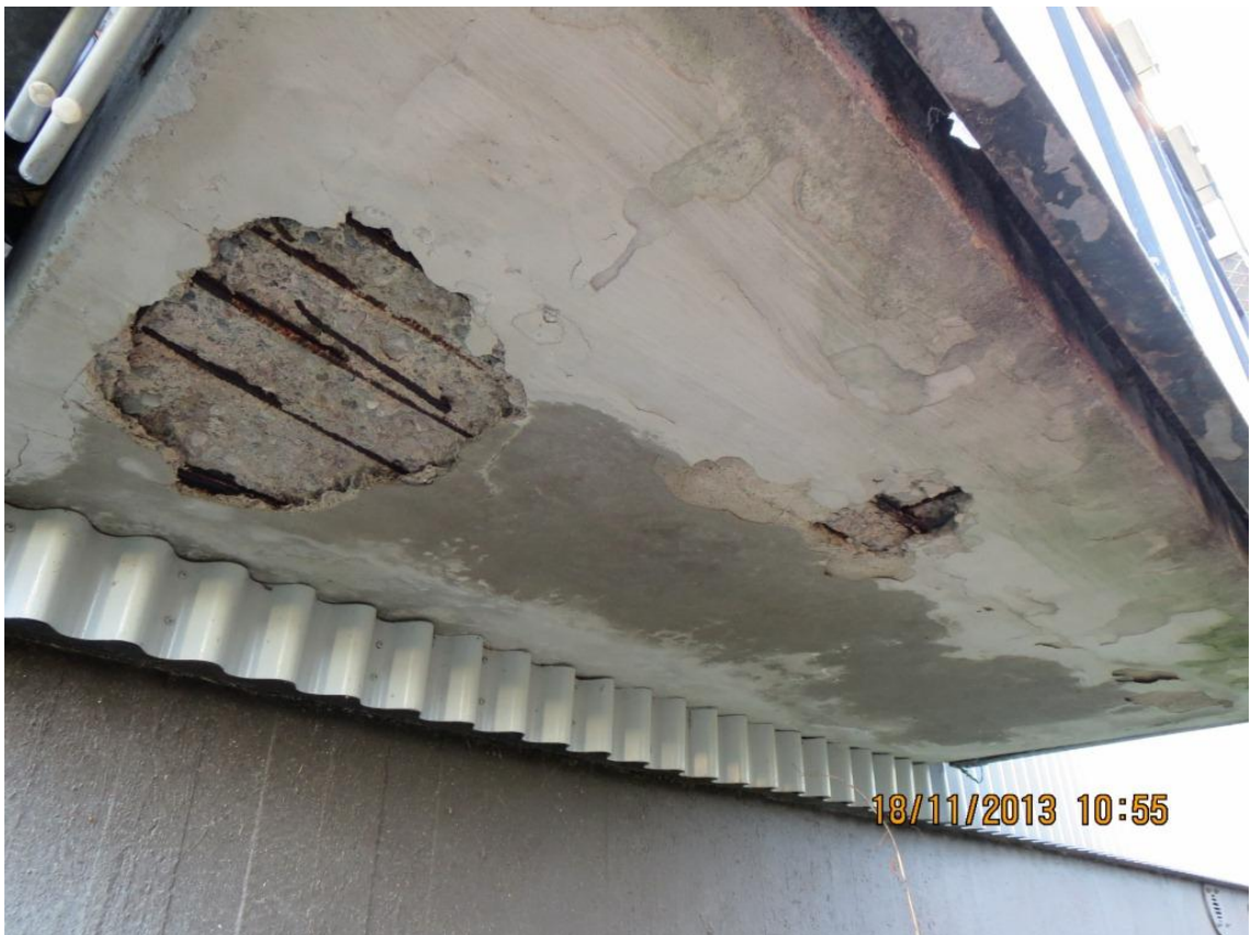
Kuva1. Parvekelaatan pohja pakkasrapautunut.
