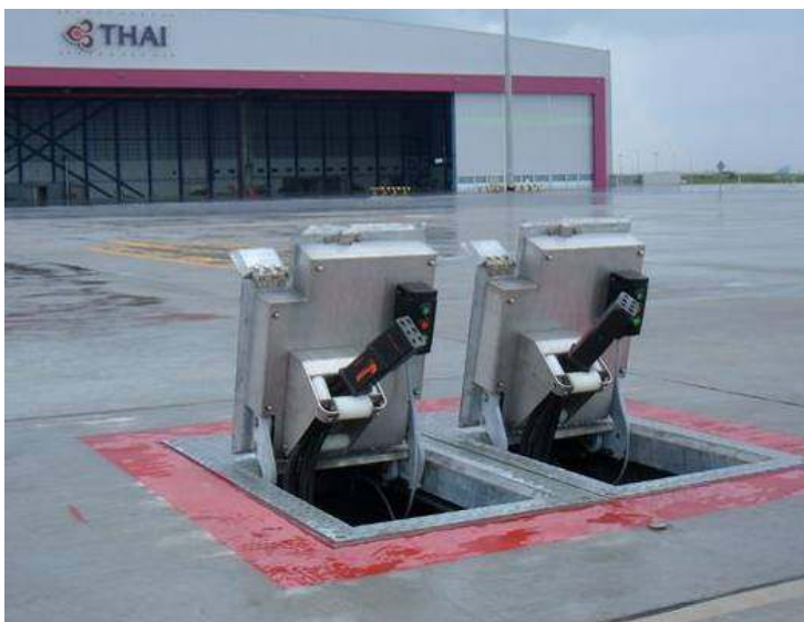
Kuva 1: Kiinteästi asennettu maavirtalaite (Gemini Transport & Communication Co n.d.)
