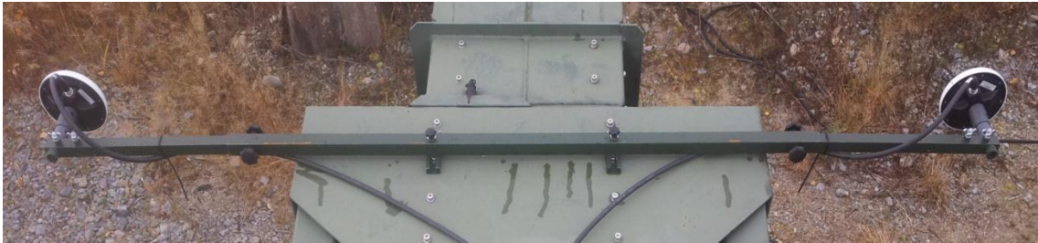
KUVA 16. Antenniteline toimintakunnossa mastossa
