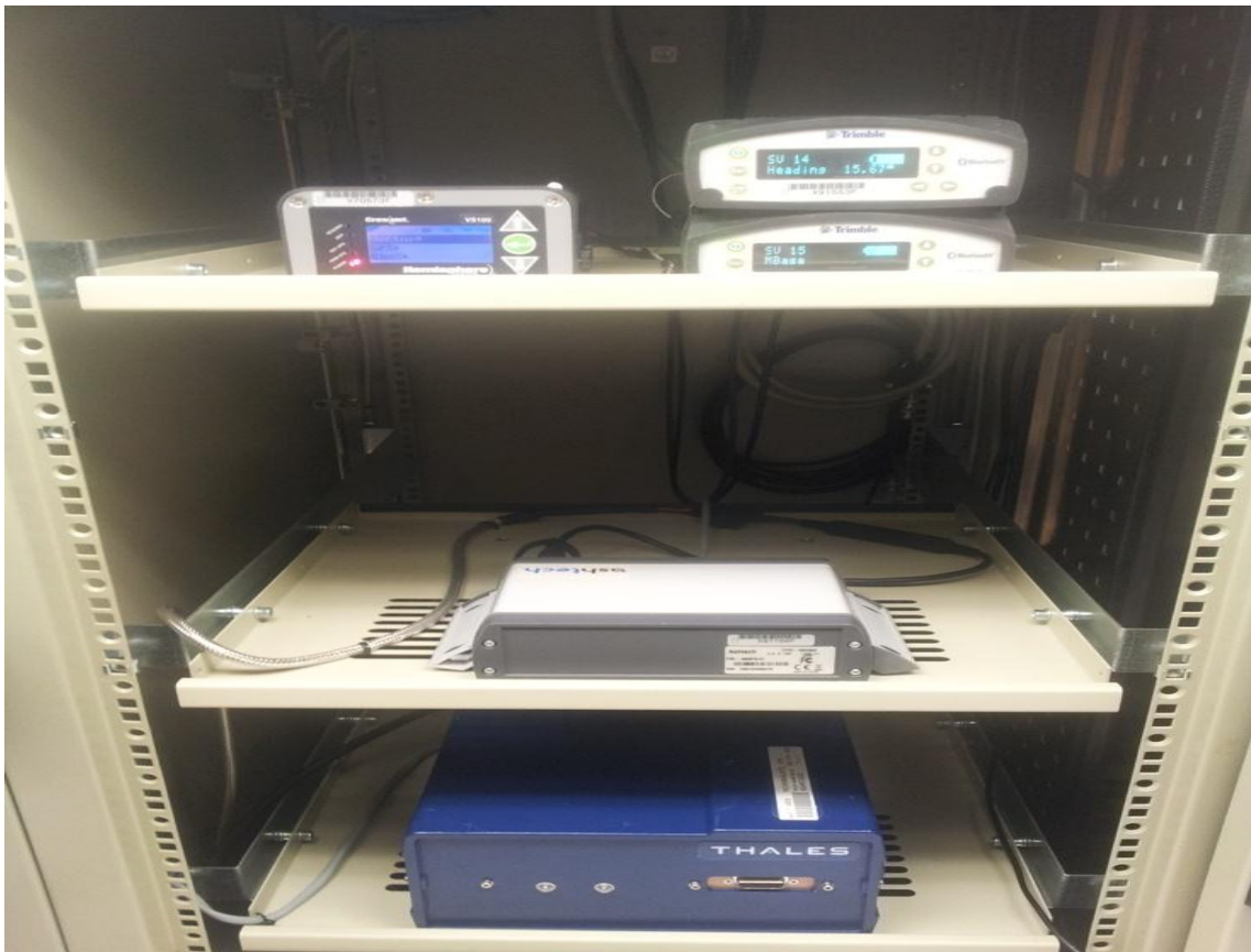
KUVA 19. Paikannuslaitteiden asennus laitekaapissa
