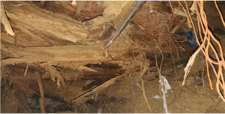
Kuvio 18 Välipohja kuvattuna alapuolelta vauriokohdasta. (Tiihonen 2023)
