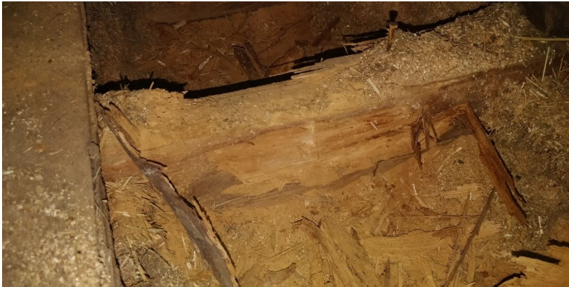
Kuvio 16 Lahovaurioitunut välipohjapalkki. (Tiihonen 2023)
