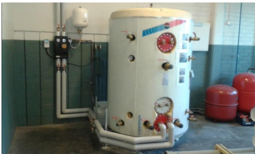
Kuva 8. Aurinkolämpöjärjestelmä kytkettynä varaajaan
