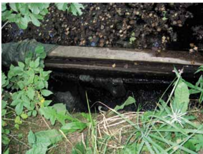
KUVA 41. Mänkilän eli Sahankulmankoskessa on huonokuntoinen settipato, joka estää kalojen nousun ylävirtaan. Kuva: Jonna Tähtinen.
