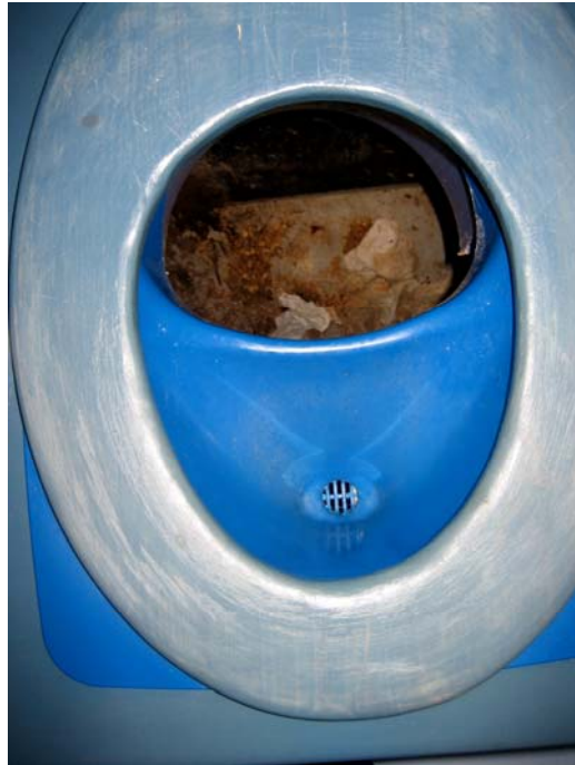
Kuva 5. Kohteen seitsemän (7) itse rakennettu virtsanerotteleva käymäläistuvin. /8/
