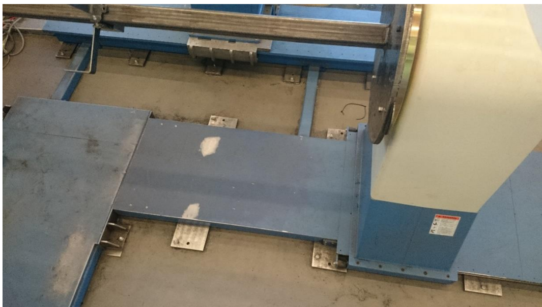
Kuva 22. Riittämätön säätövara. (Salmi 2010-06-13)
