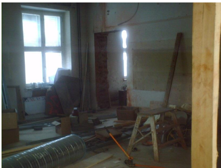
Kuva 8. Huono työmaajärjestys ( Pitkänen, 2014-04-22).
