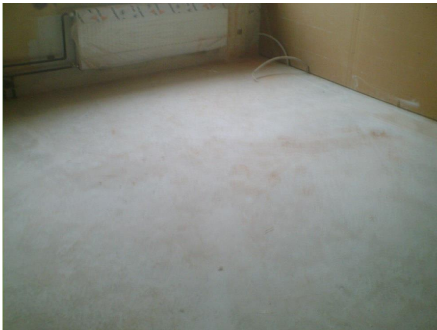
Kuva 6. Loppusiivottu tila, jossa ei synny enää karkeaa likaa, kuten betonipalasia yms. Tekemättä on vielä pinnoitteet puhtaaseen pintaan sekä sähköasennuksia. (Pitkänen, 2014-04-22)
