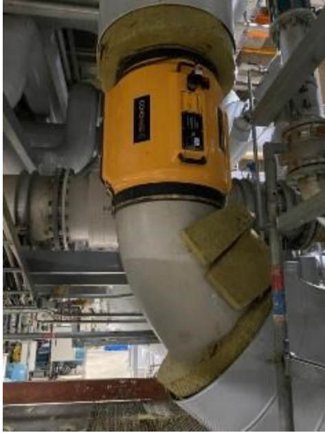
Kuva 35. Echowise DN600 anturi asennettuna alatasolle DD-pesurin syöttöön
