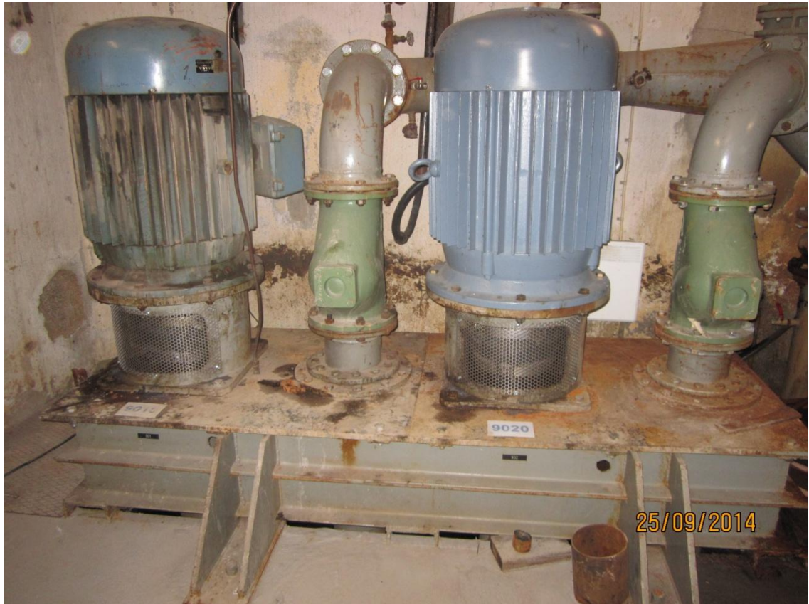
Kuva 4. Kanavan käyttövesipumput 901 ja 902.
