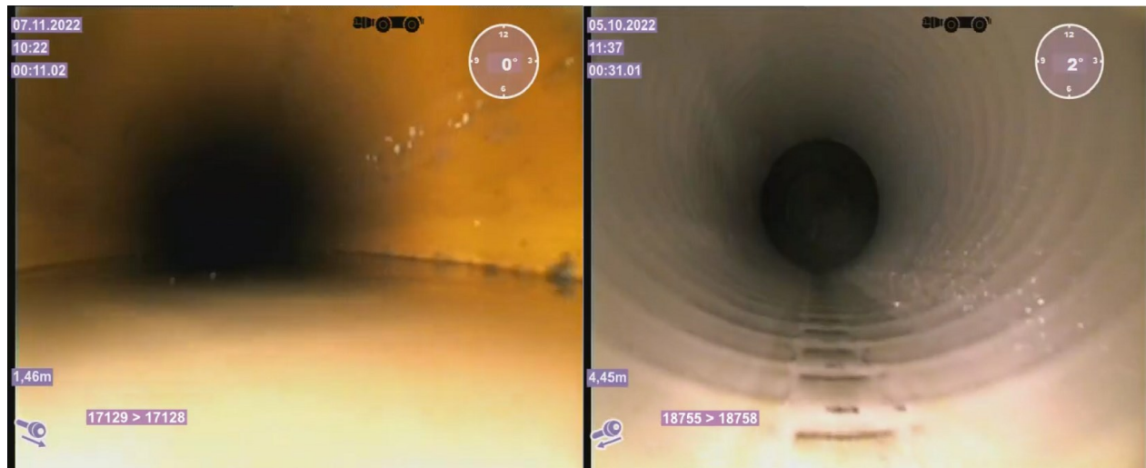
Kuva 12. Vasemmalla putki, jossa on painuma ja putken täyttö aste on noussut noin 40 %, oikealla ehjä putki. (29)
