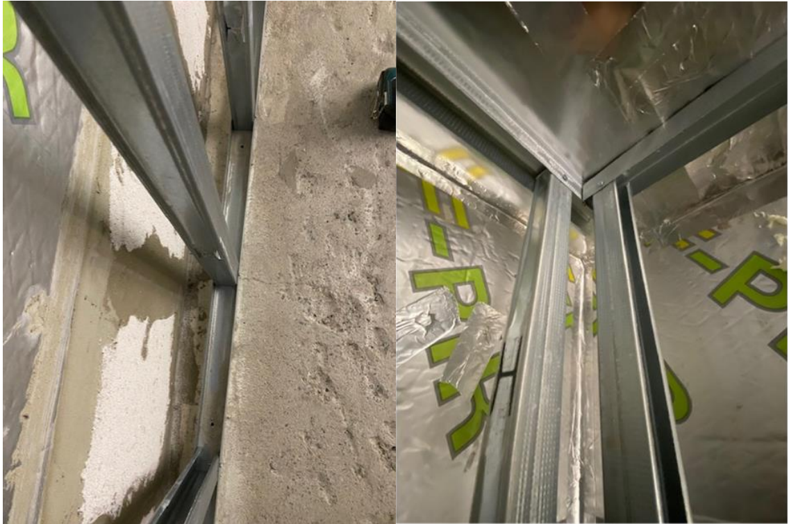
KUVA 13A. Lattiakisko ja läppäranka KUVA 13B. Läppäranka ja kattokiskot
