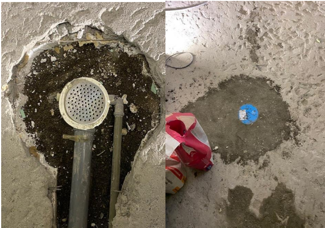
KUVA 7A. Saunan lattiakaivo auki.
