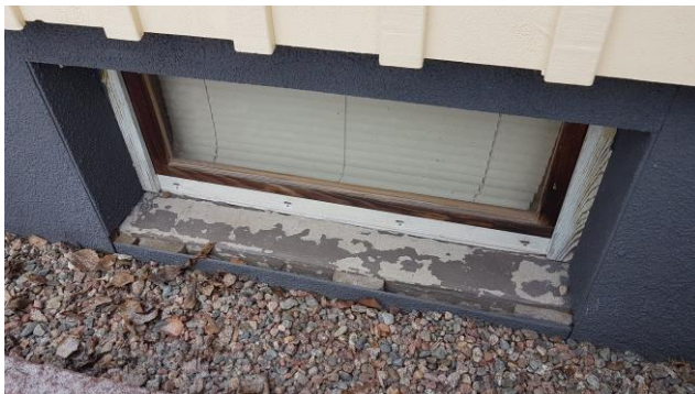
KUVA 24, Kellarin ikkunan puuttuva vesipelti
