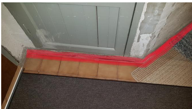
KUVA 6, Kosteushavainnot seinien vierustoilla
