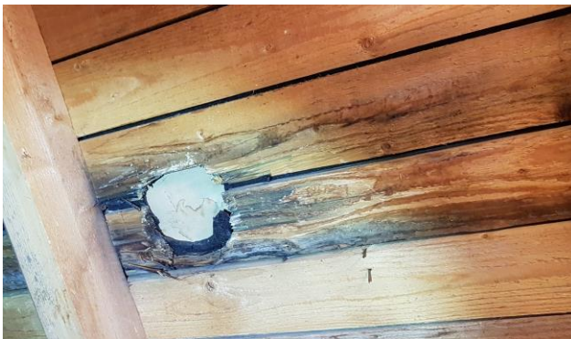
KUVA 18, Vanha läpivienti vesikatossa
