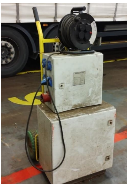
Kuva 22. Liikuteltava muuntaja. Uusitalo 2023.
