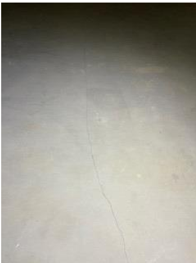
KUVA 14. Lattian pintahalkeilua ja kovalevyjen aiheuttamaa värjäämää (Nikula 2024).
