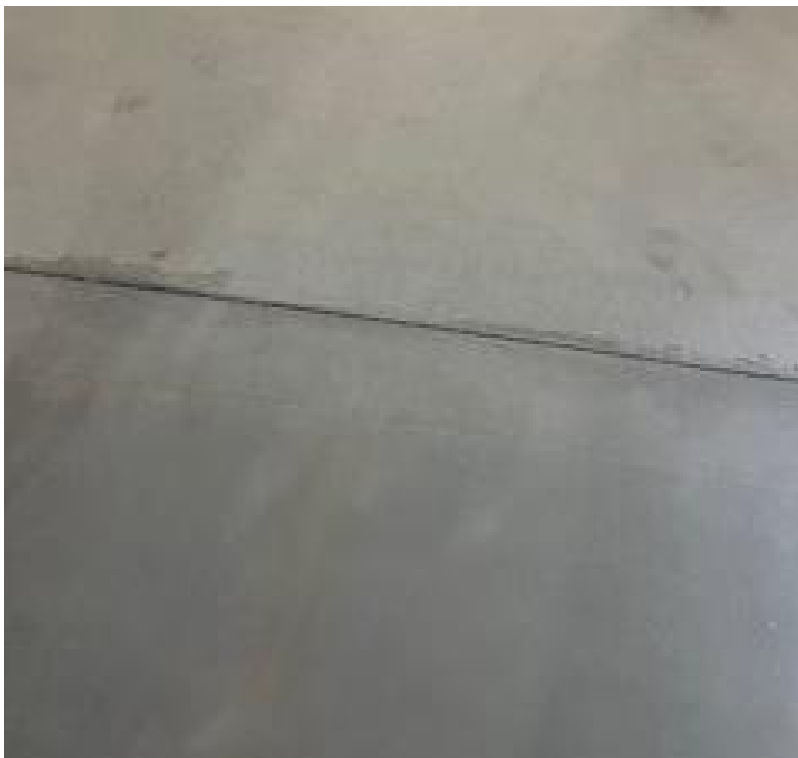
KUVA 13. Betonilaattojen värierovaisuudet (Nikula 2024).
