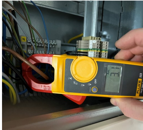
Kuva 6. PK62a sähkötehon mittaus
