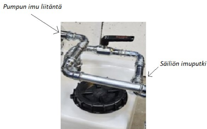
Kuva 16. Pumpun imu puolen putkitus.
