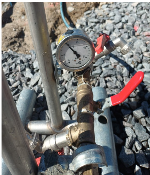
KUVA 12. Painemittari koeponnistuslaitteessa (Turunen 2023, CC BY-SA)
