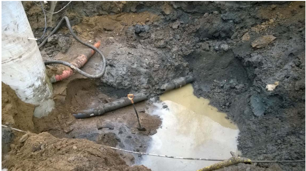
Kuva 18. Kilsan jätevedenpumppaamon paineviemärivuoto
